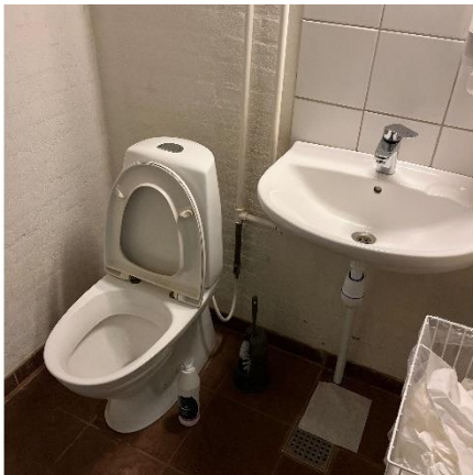
Toilet og vask i omklædning
