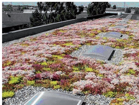
En tagbeplantning i lave vækster med en varme-isolerende funktion – og fin at kigge ud på. Foto: Zinco.dk
