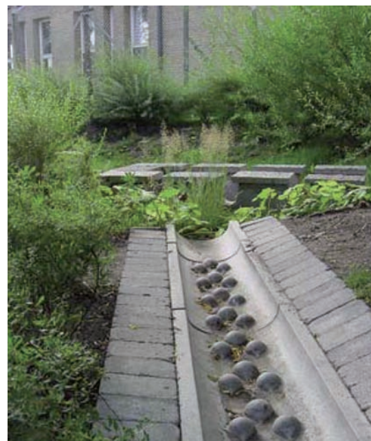
Regnvand kan afledes i en grøft, som indgår i det omgivende miljø. Malmö. Foto: Århus Kommune.
