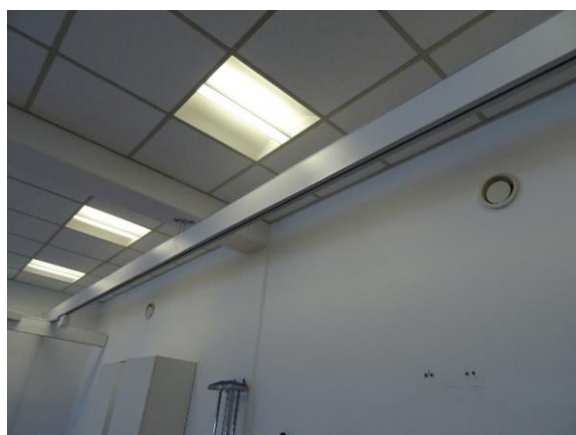
Udsugningsarmaturer vest for forbindelsesgang
