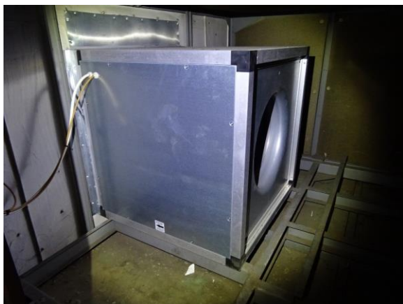
Ny ventilator i gammelt anlæg
