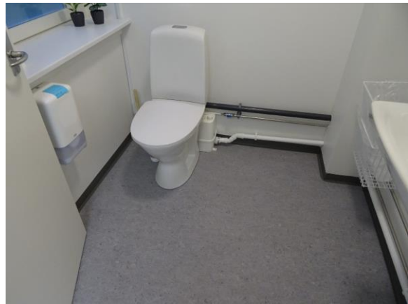
Toilet i kælder med afløbspumpe
