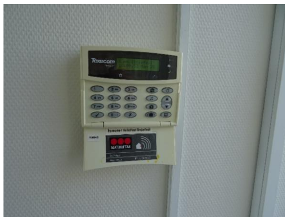
AIA kodetastatur, ældste alarm
