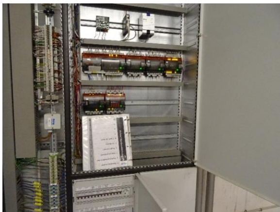
CTS tavle kælder, ventilation
