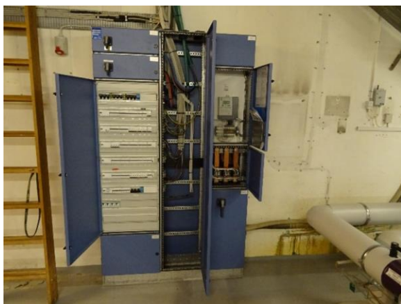
Eltavle i kælder fra 2017
