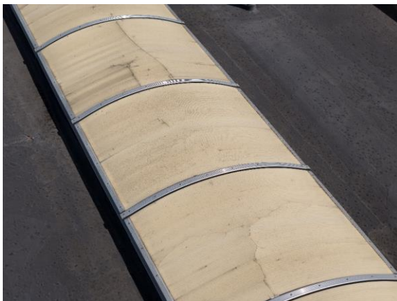
Rytterlys i plast, revnet og hullet
