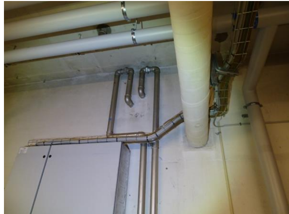
Afløb fra pumpe
