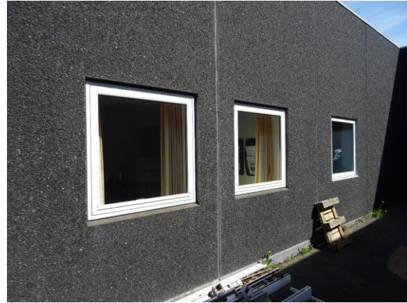
Trævinduer fra 2003 mod øst mindre udsat
