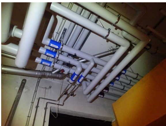
Fordelingsrør i kælder
