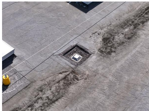
Revner i påsmurt membran
