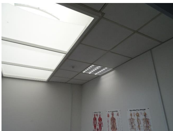
Retrofittede armaturer i behandling
