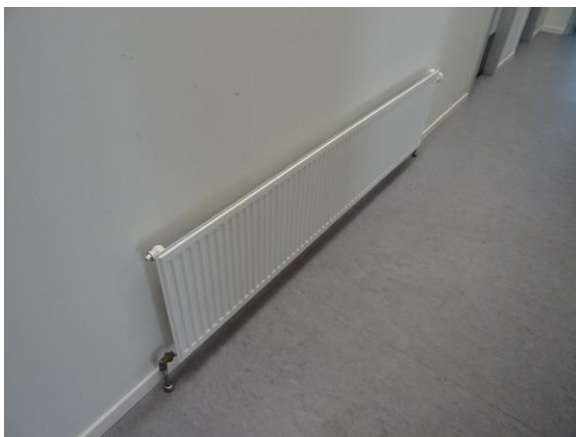
Radiator fra opførelsen, et lag
