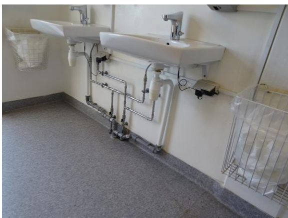
Rustfrie rør på 1. sal
