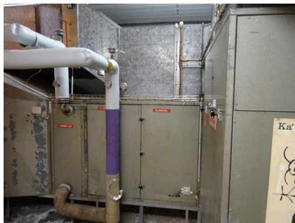
Gammelt anlæg og varmeblade
