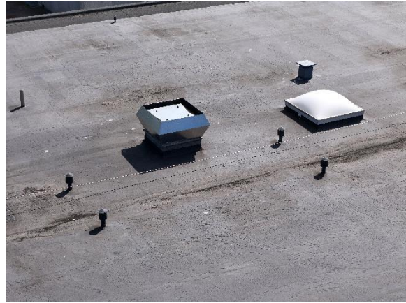
Tagventilator 1 af 3 for hovedbygning
