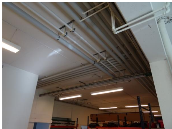
Fordeling vand og varme i 2003 bygning lager
