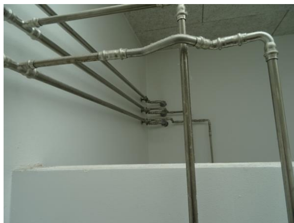
Rustfrie rør uisoleret i omklædning
