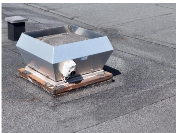
En af tre tagventilatorer for vestbygninger
