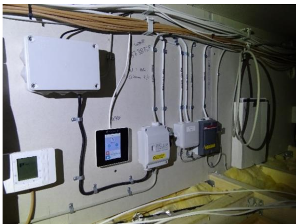
Ventilationsstyring anlæg fra 2020
