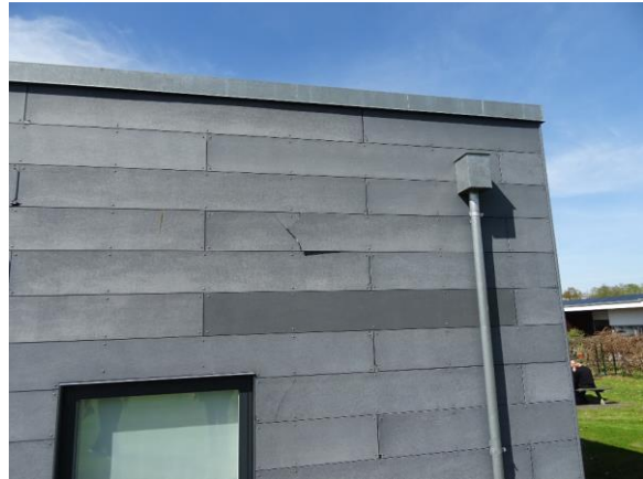
Pladebeklædning fra 2020, alle er revnet
