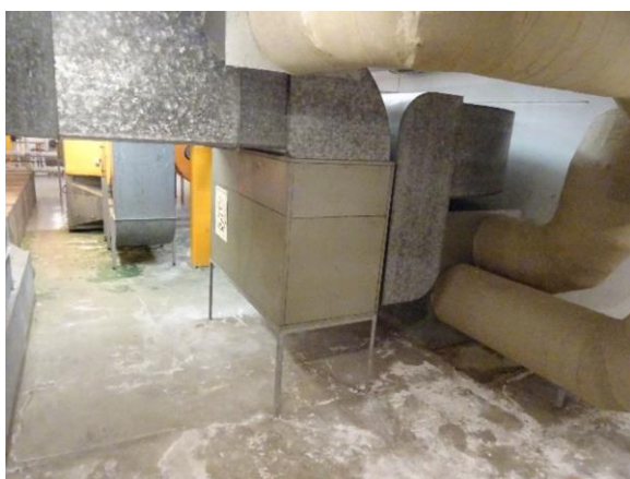
Kanaler i kælder
