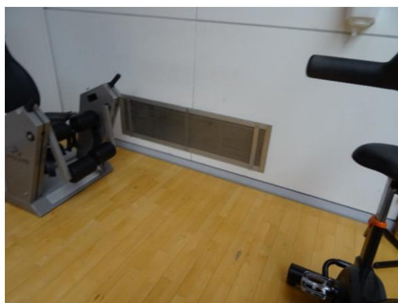
Udsugningsarmatur i gymnastik, snavset
