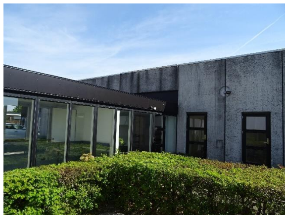
3-lags energiruder i gang
