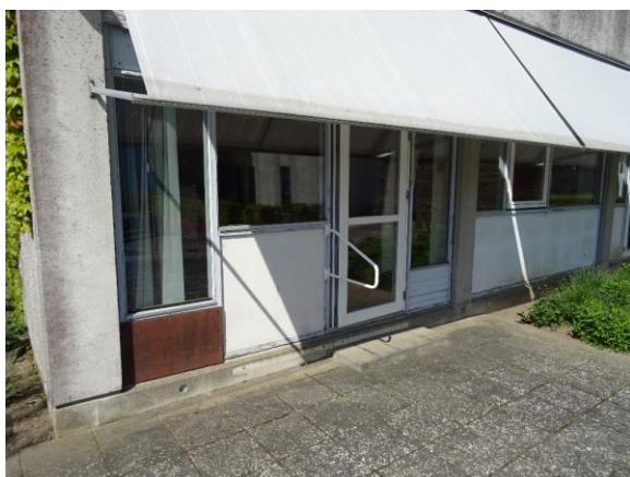
Termoruder i gamle facadepartier, bemærk reparation med krydsfinerplade
