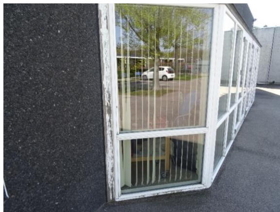
Vinduespartier fra 2003, mangler malervedligehold
