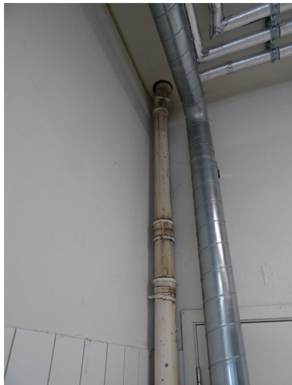
Tagnedløb indvendig i sterilcentral med skimmel pga. kondens
