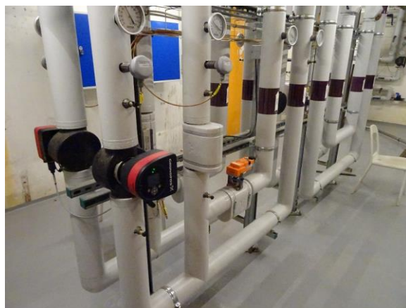
Hovedfordeling til varmeanlæg
