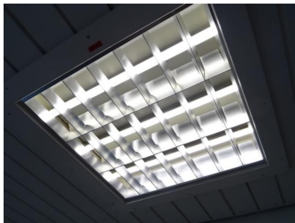
Gammelt armatur med LED rør
