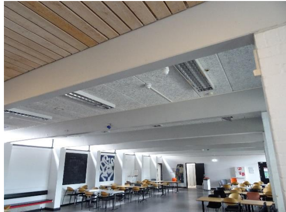
Forhal til sportshal, armaturer med lysstofrør
