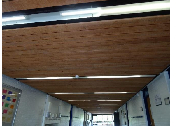
Retrofit med LED rør i gang, giver dårligt lysudbytte
