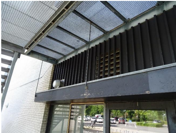
Afkast for ventilation fra klasser i nordfløj.
