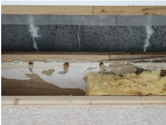
Kalkudfældninger fra betondæk og tæring på skruer
