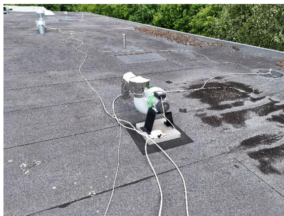
Kabler flyder mange steder på taget
