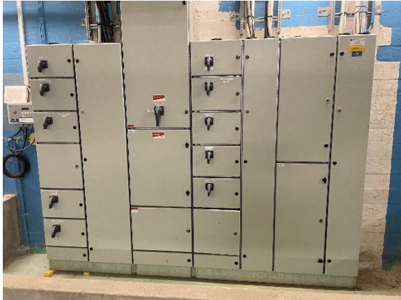
Hovedtavle i varme kælder
