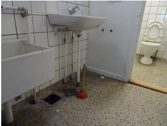
Ældre galvaniseret rørføring
