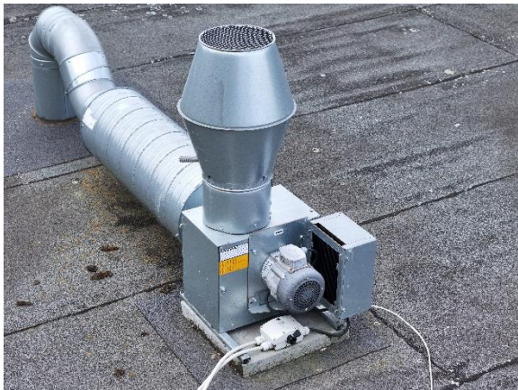
Udsugning fra 2021, ombygning. Afbryder ligger på sokkel.
