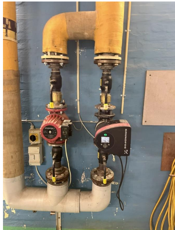
Varmecentral, kun backup pumpe er ældre UPE pumpe
