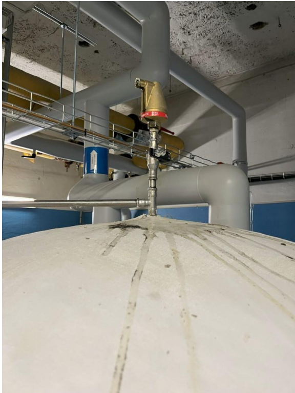
Utæt automatudluffer. Isolering gennemvædet.
