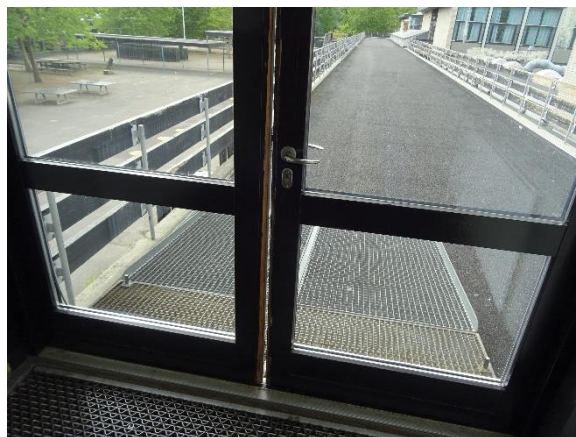
Dørparti med tydelig sprække – under udbedring
