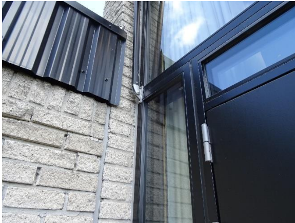
Mindre område skadet murværk
