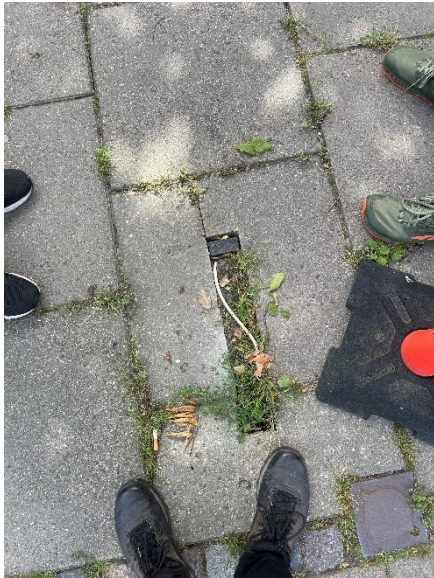
Ikke korrekt afsluttet kabel foran hovedindgang
