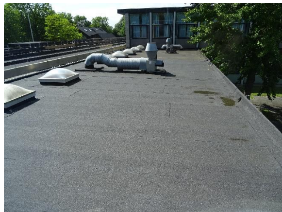
Ventilation over lærerværelse
