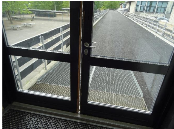
Dørparti med tydelig sprække – under udbedring
