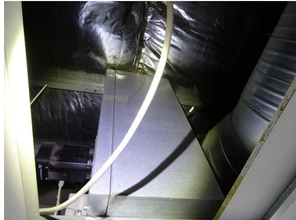
Udsugningsanlæg for klasser over lofter i gang og afkast gennem nordgavl
