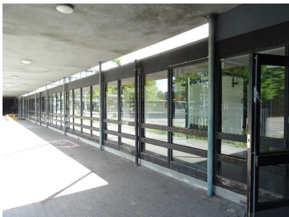
Forbindelsesgang med termoruder
