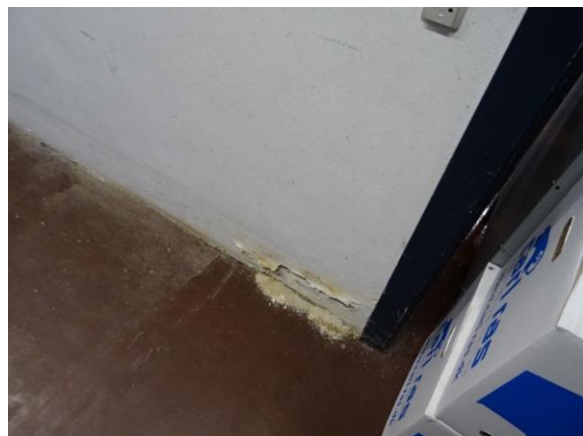
Skader på kældervæg
