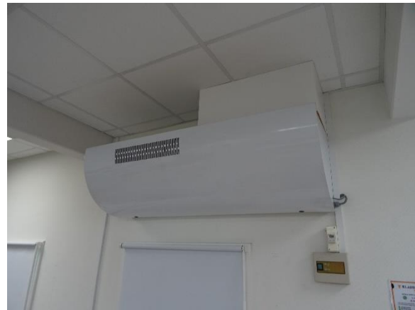
Decentralt Turbovex anlæg på kontor
