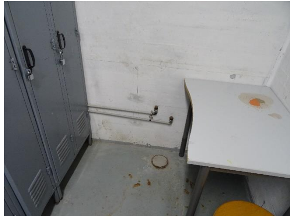
Døde rør i kælder
