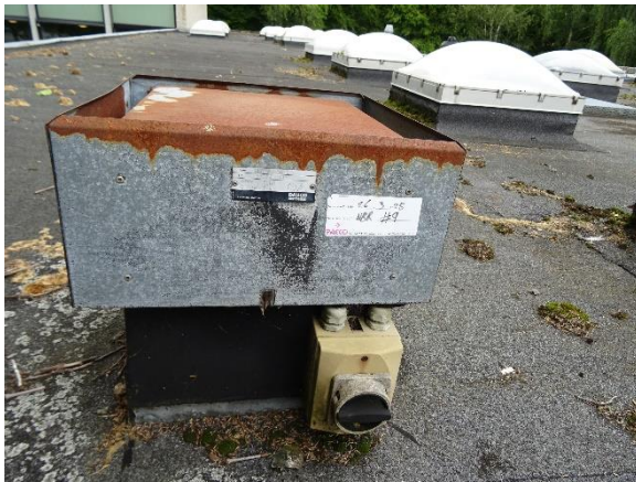
Aftrækshætte kraftigt rustanløben zink i galvanisering nedbrudt.
