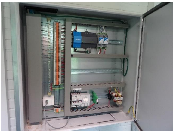
Controller for ventilation 1. sal natur og teknik
