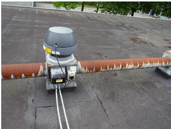
Gammel spirorør hvor galvanisering er nedbrudt. Ny aftræksventilator.
