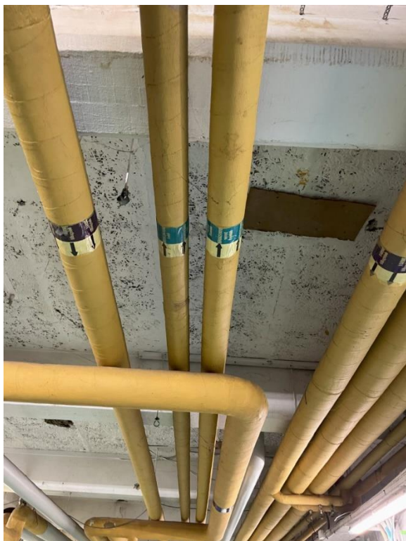
Varmt vand og cirkulation i kælder
