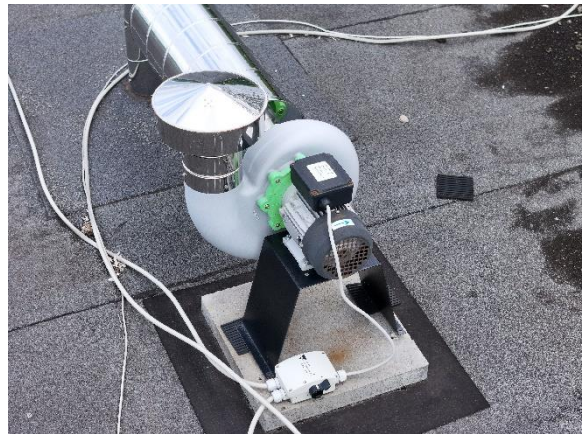
Udsugning fra natur/teknik, kemikalieresistent ventilator.
