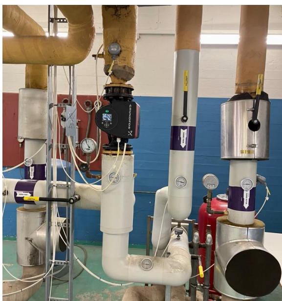
Generelt nye pumper i installationer
