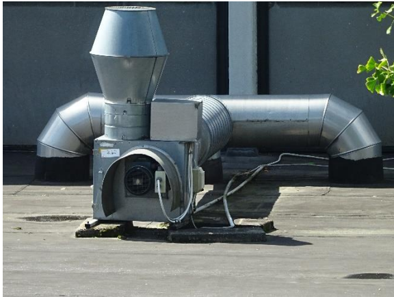
Boksventilator over lærerværelse
