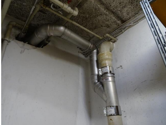
Faldstammer i kælder delvist repareret med rustfri
