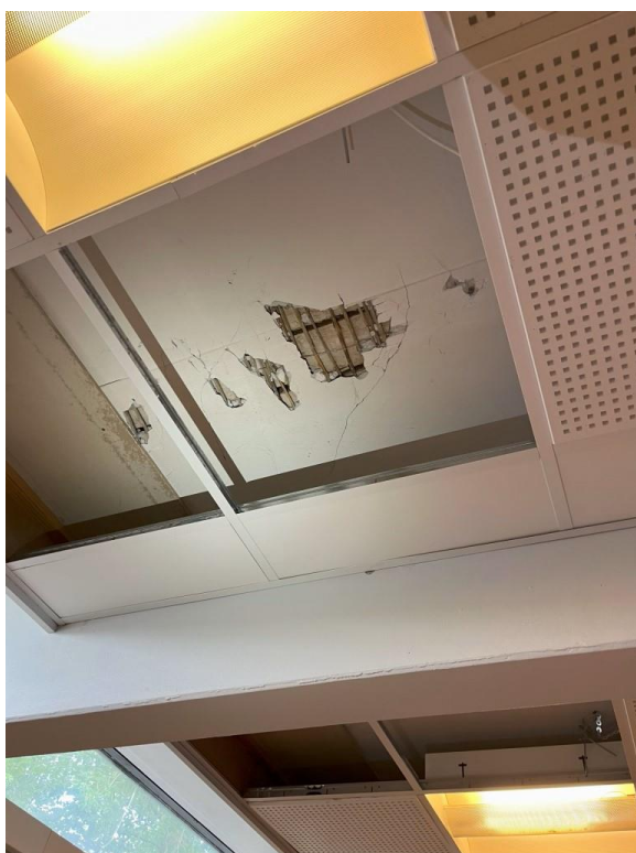
Loftplader var afmonteret i hjemkundskabslokale og tydelige skader på loftpuds. Uhygiejnisk.
