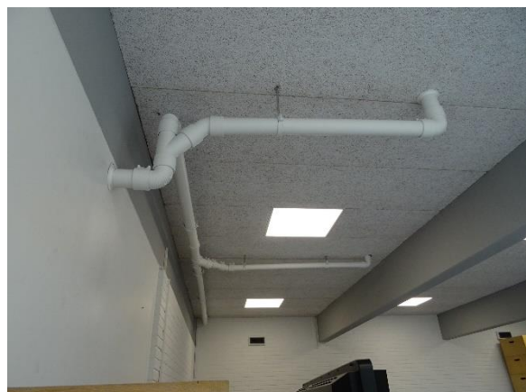
Afløb fra faglokaler på 1. sal. Plast gennemføringer skal sikres mod brandspredning.
