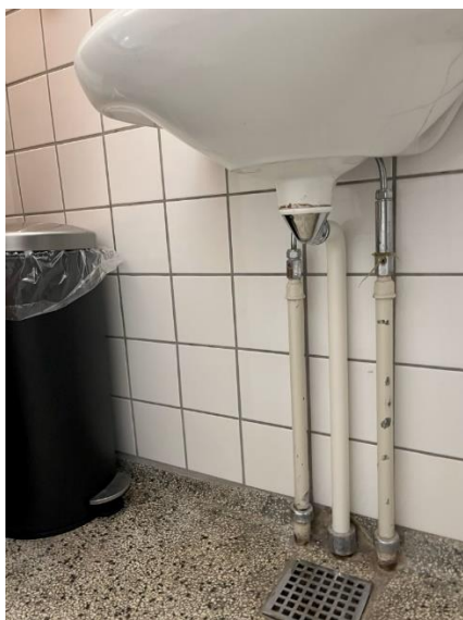
Ældre galvaniseret rørføring
