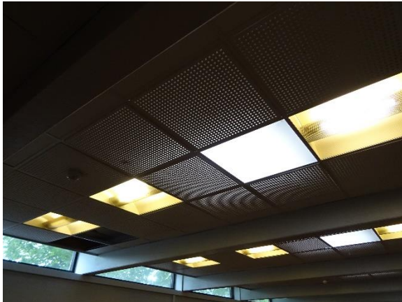
Skolekøkken, ældre Glamox armaturer med 55 W kompakt-rør
