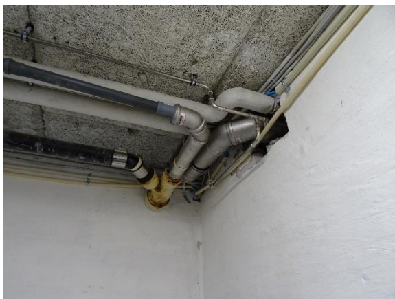
Nedbrudte mønteringer der er på vej ud.
