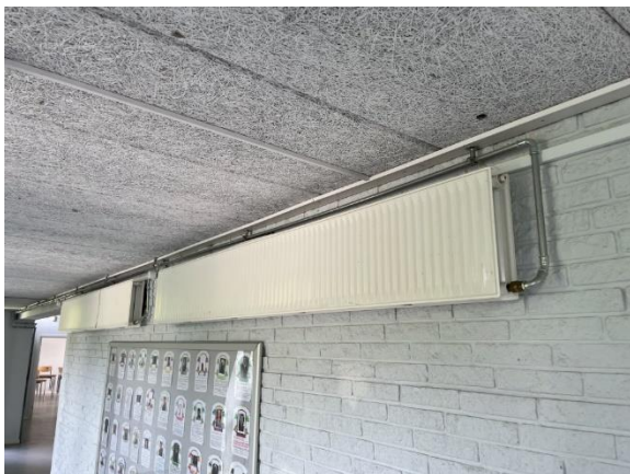
Nyere konvektor under loft og rørføring
