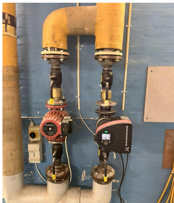
Ældre pumpe anvendt i kaskade/backup med ny Magna
