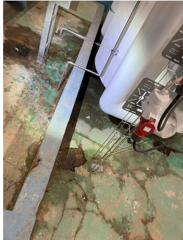
Store mængder vand fra utæt automatudluffer.
