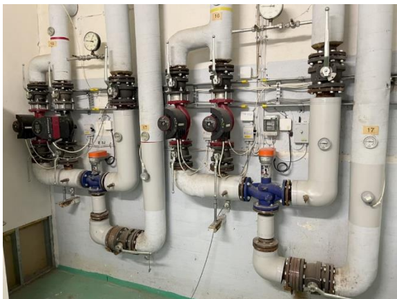
Varmecentral, trykstyrede pumper
