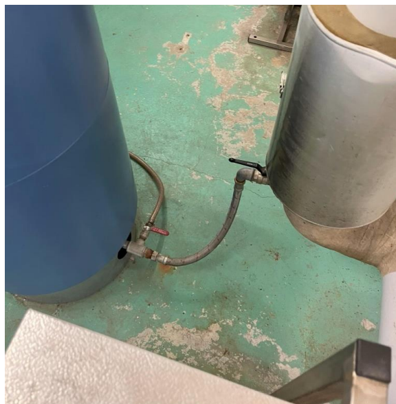
Installationen er ulovlig da der mangler kontraventil.
