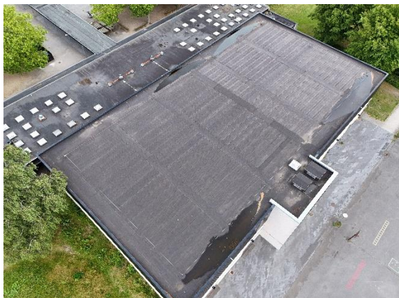
Tag på hallen isoleret til 0,13 W/m²K ca. 300 mm isolering
