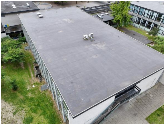
Tag på nordøst bygning med flydemembran
