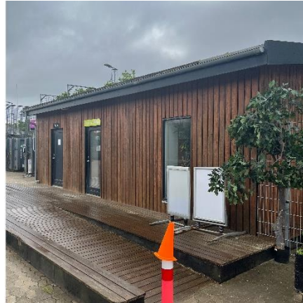
G5 Pladedør til toilet dør til undervisning med tolags energirude
