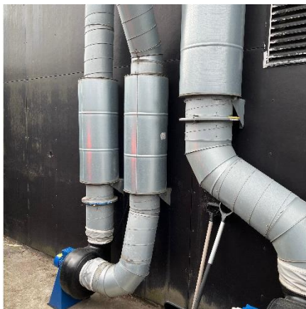
Nye ventilatorer til procesudsug
