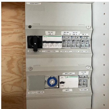
G5 Tavle i undervisningsbygning
