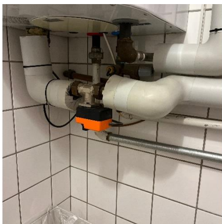
G3 Varme- og brugsvandsrør
