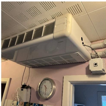
G3 Luft/luft varmepumpe i omklædning
