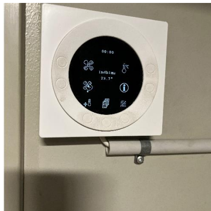
Kontrolpanel til komfortanlæg
