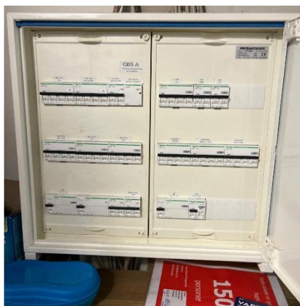
G7 Tavle i byttehus
