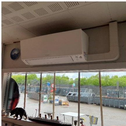
G3 Luft/luft varmepumpe i kontor
