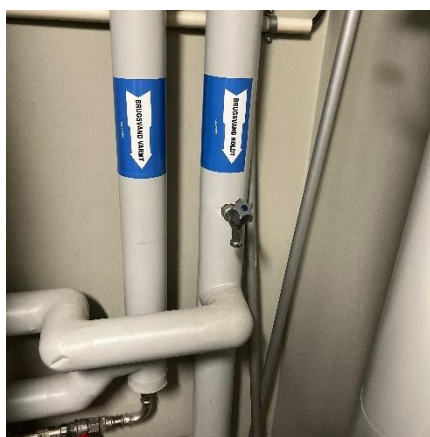
G6 Brugsvandsrør i teknikrum
