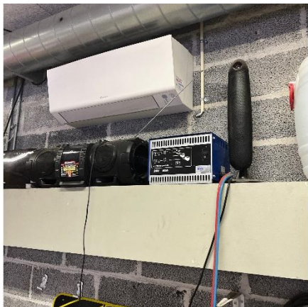
G6 Luft/luft varmepumpe i sortering til farligt affald
