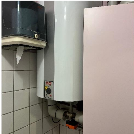
G3 Varmtvandsbeholder på toilet
