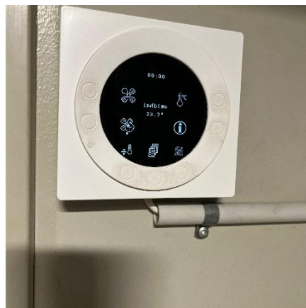
Kontrolpanel til ventilationsanlæg
