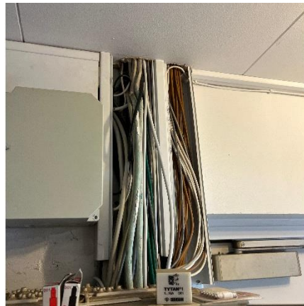
G3 Kabel låg til plastkanaler mangler
