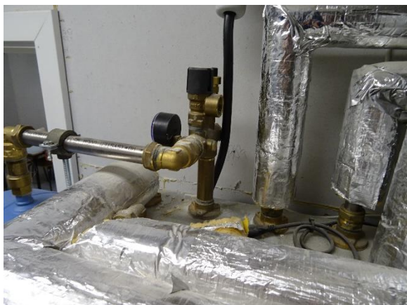
Overtryksventil fra varmeanlæg afvander ovenpå varmepumpe
