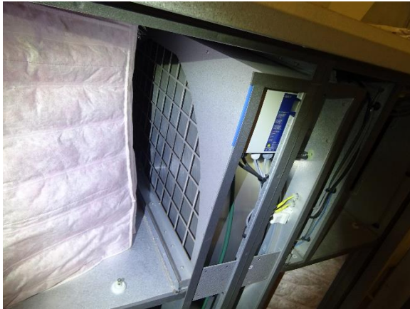
Rotorveksler og filtre
