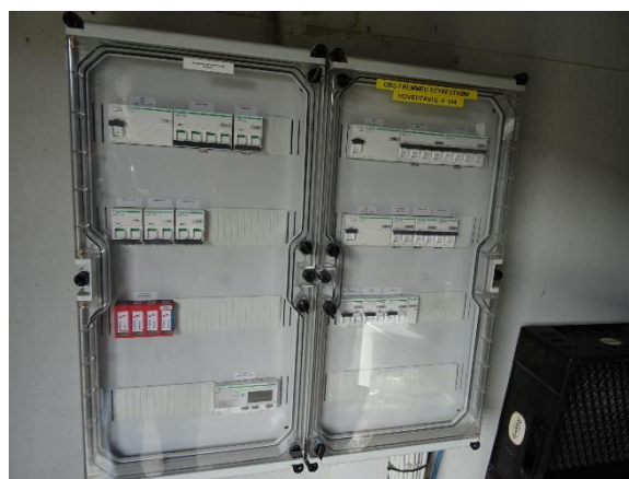
Eltavle i staldbygning
