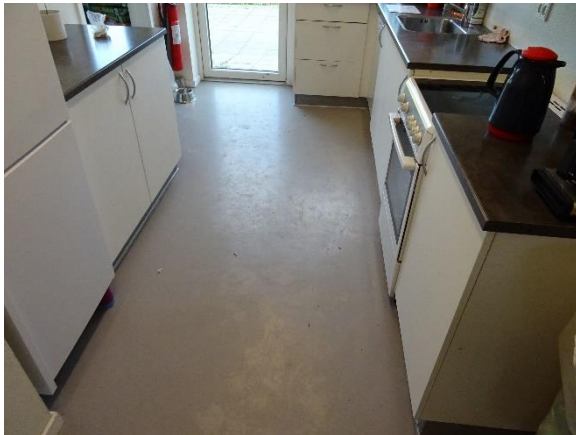
Epoxygulv i køkken
