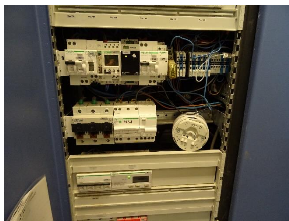
Ulovlig installation i tavle. IHC lampeudtag bygget direkte ind i tavle og afdækning fjernet.
