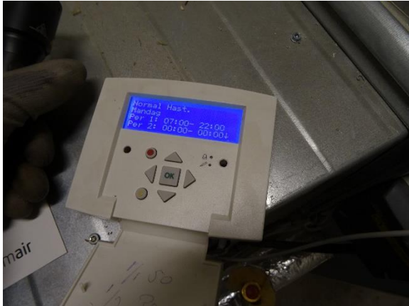
Håndterminal ved ventilationsanlæg.
