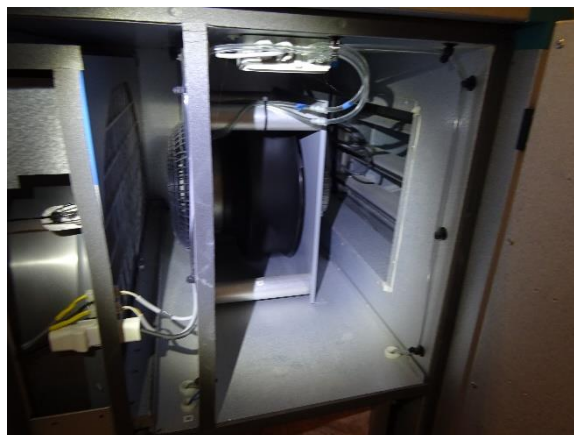
Ventilator i anlæg
