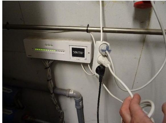
Elforsyning til gulvvarmestyring
