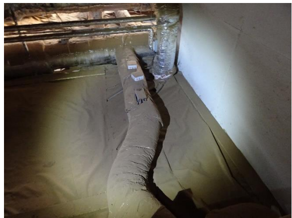
Ventilationskanaler og loft dækket af støv
