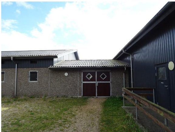
Dobbeltdør forbindelses bygning mellem hal 1 og stald
