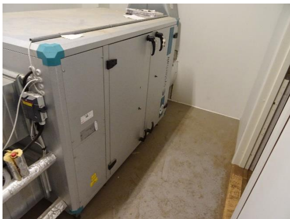
Ventilationsanlæg i teknikrum på loft
