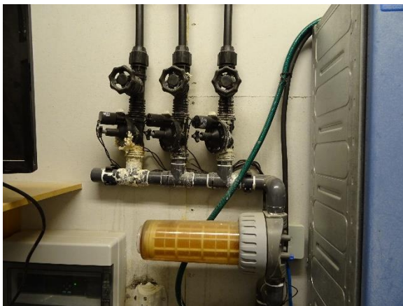
Afspærringsventiler og vandfilter til vandingsanlæg
