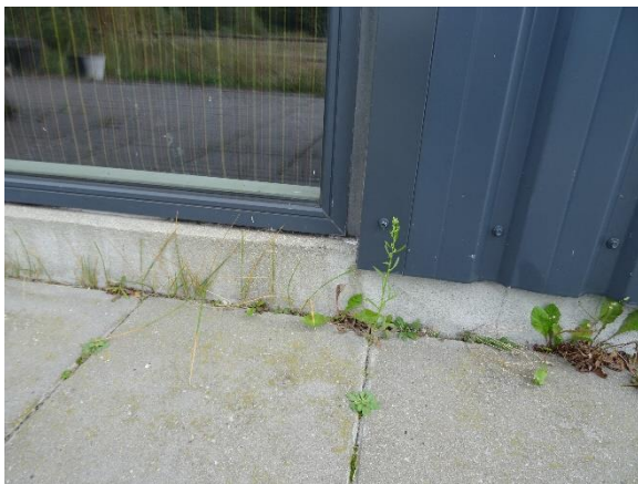
Sokkel, mindre revne i puds
