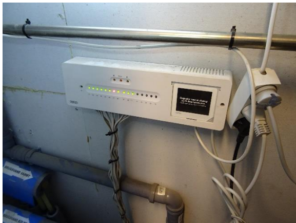
Gulvvarmestyring tilsluttet stikdåse
