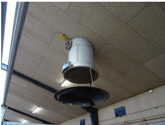
Udsugningsventilator i stald
