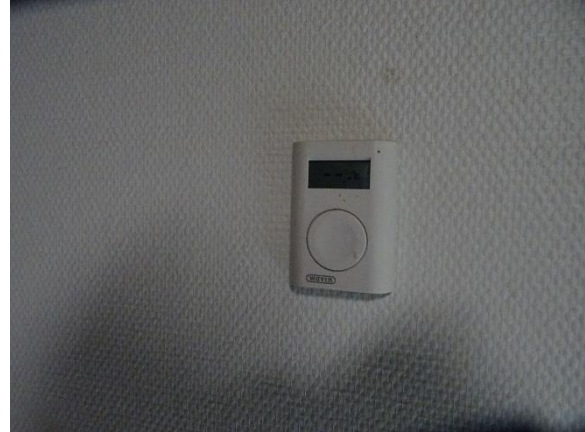
Rumtermostat for gulvvarme
