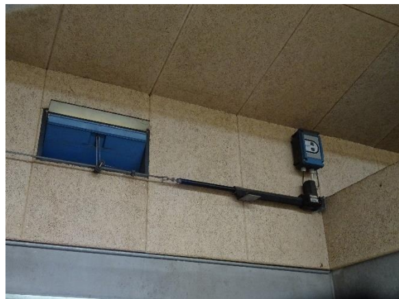
Spjældstyring, del af ventilationsstyring staldbygning
