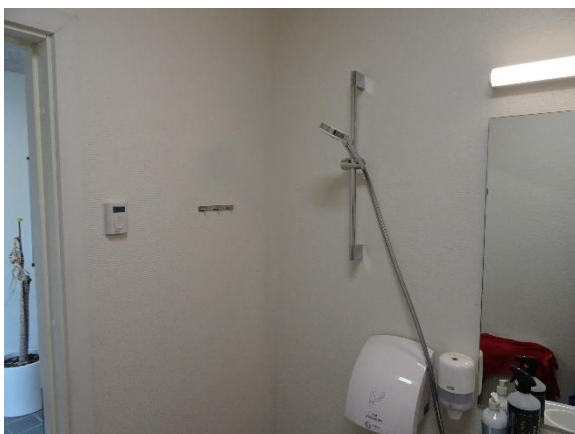
Bruseniche i område der ikke er egnet som vådzone. Bemærk elektrisk håndtør i vådzone.
