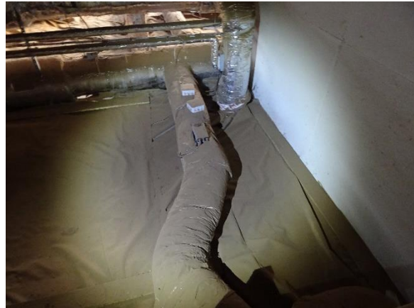
Kanaler og spjæld dækket af støv fra ridehal
