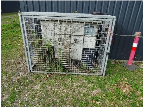
Eltavle ved gavl, hal 1
