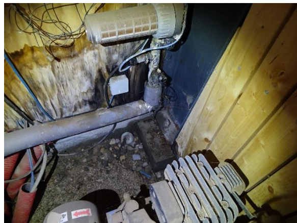
Vandrør og følger af vandskade ved vandingsanlæg
