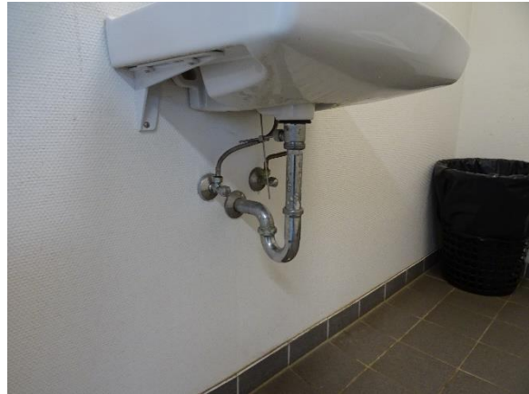
Afløb under håndvask
