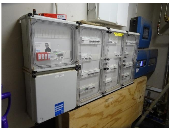
Eltavle i staldbygning
