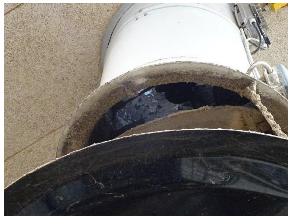
Udsugningsventilator i stald
