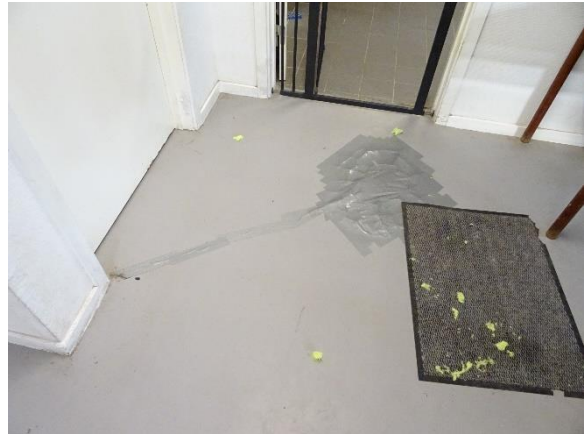
Krakeleret epoxygulv lappet med tape
