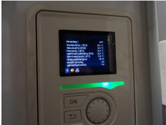
Varmepumpe styring inkl. varmtvandsproduktion
