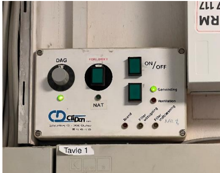
Styring til anlæg 3
