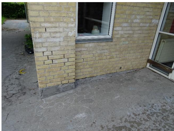
Pudsskader på sokkel og skadede fuger
