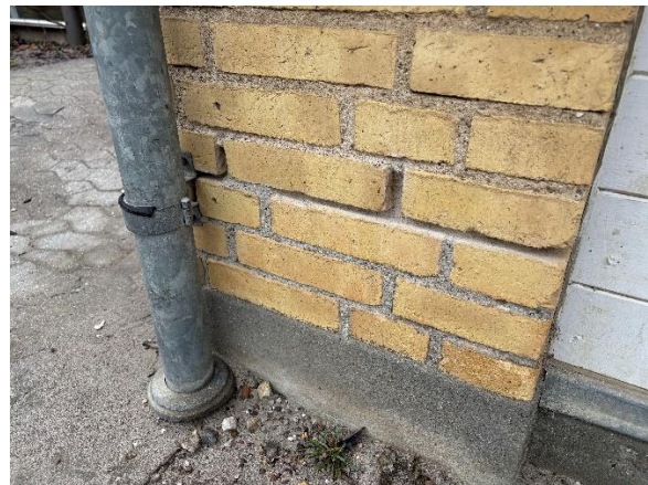
Murværk med udvaskede fuger
