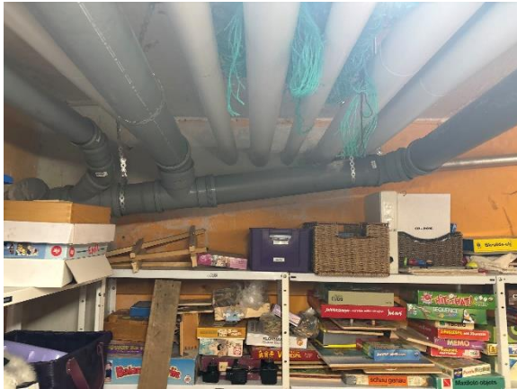
Varme- og varmtvandsrør i kælder
