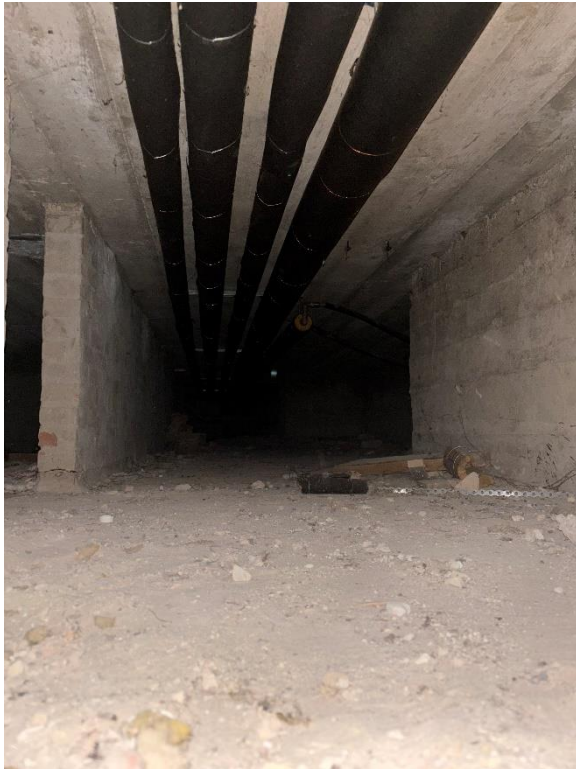
Varmtvandsrør i krybekælder
