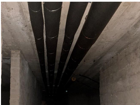
Fordelingsrør i krybekælder
