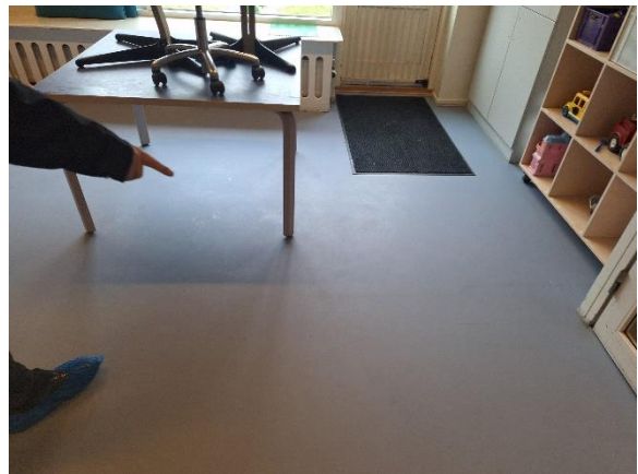
Linoleum i det fleste rum. Fremstår både med og uden skader og sluppet svejsninger
