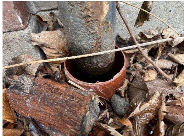
Nedløb mangler brøndkrave.
