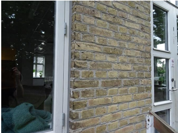
Murværk fra 1900 med brændte fuger
