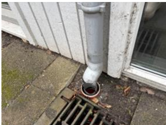
Nyere PVC sandfangsbrønd. Mangel på oprensning. Sokkelknæ udbedret forår 2025.
