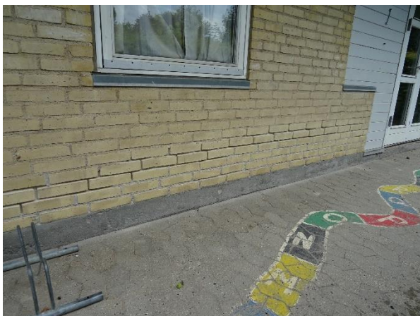
Fuger fra 1994 skadet af saltning
