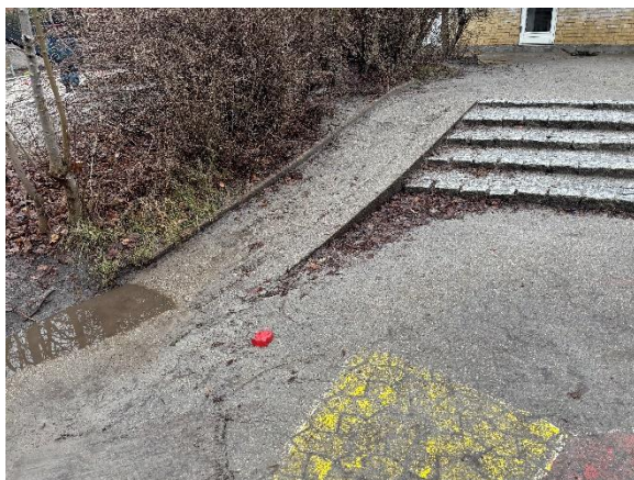
Rampe, med en del sætningsskader Belægning udført i SF-sten
