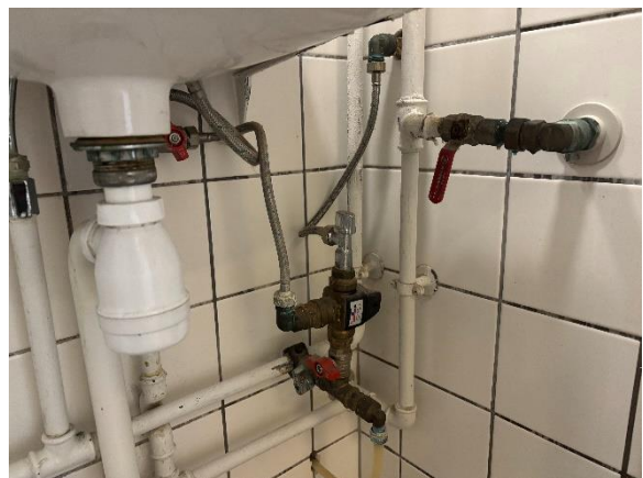
Stålrør og termostatisk blandeventil under vask
