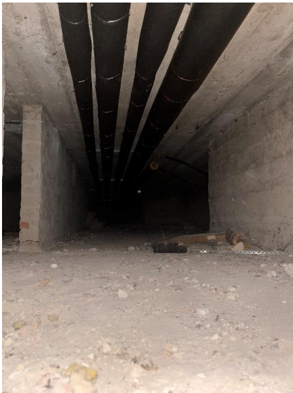
Varmerør i krybekælder
