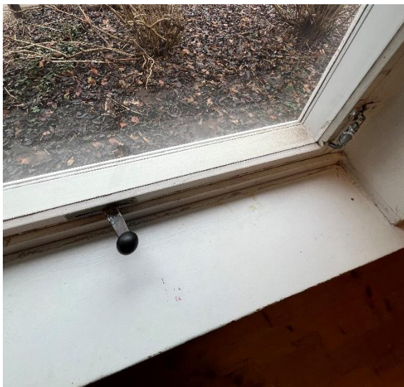
Vindue med koblet ramme fra 1954
