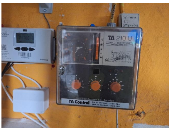
+30 år gammelt klimastatanlæg, der er overgået til CTS
