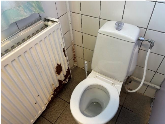
Radiator, rusten pga. plavering ved toilet
