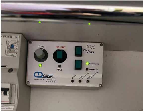
Styring (1 af 3) af ventilationsanlæg
