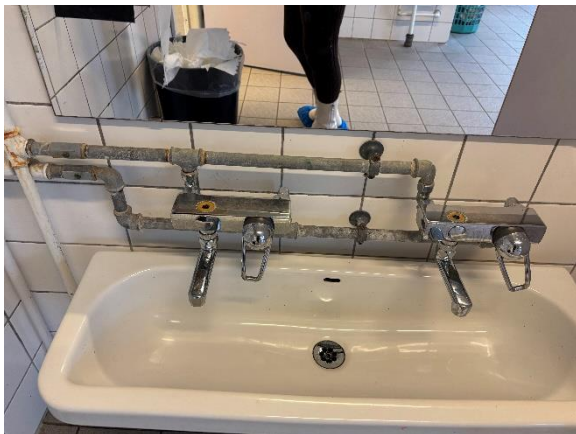
Stålrør ved vaskerende, tæring ved T-stykke
