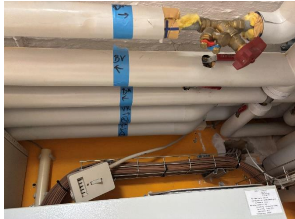
Varme- og varmtvandsrør i kælder
