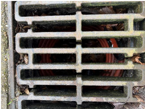
Nyere PVC sandfangsbrønd. Mangel på oprensning.
