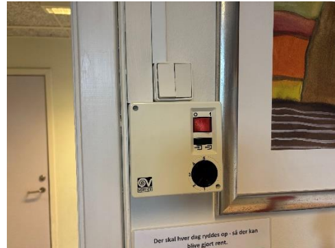
Styring til anlæg 4
