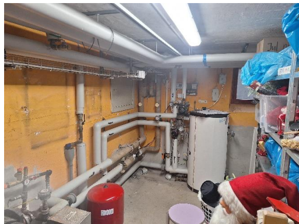
Varmtvandsbeholder og rør i kælder
