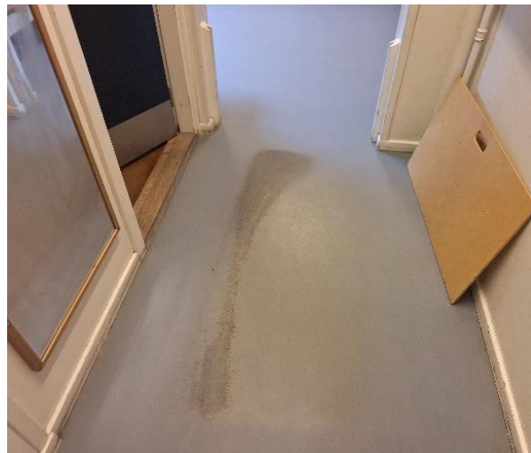
Linoleum er meget slidt. Info om at udskiftning kommer snarest.
