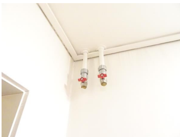
Døde rør i omklædningsrum fra nedtaget vask
