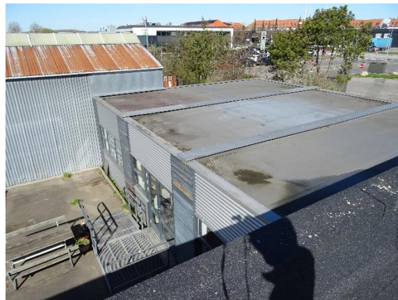
Tagdug i PVC på pavillon fra 2016
