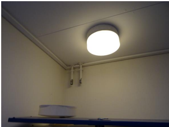
Kompaktrørsarmatur på toilet
