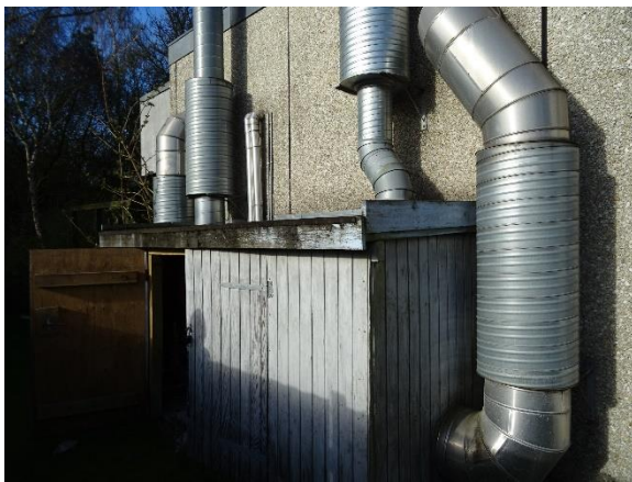
Ventilationsanlæg østgavl (ikke idrift)
