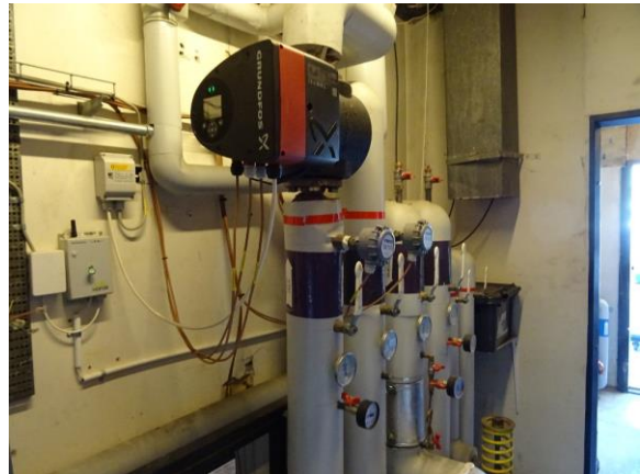
Hovedfordeling pumpe og rør
