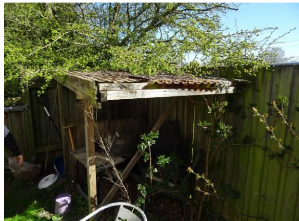
Halvtag øst for bygning. Tjenlig til nedrivning.
