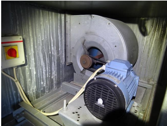
Ventilationsanlæg på tag
