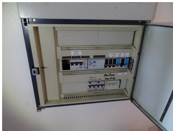
Undertavle i opholdsrum
