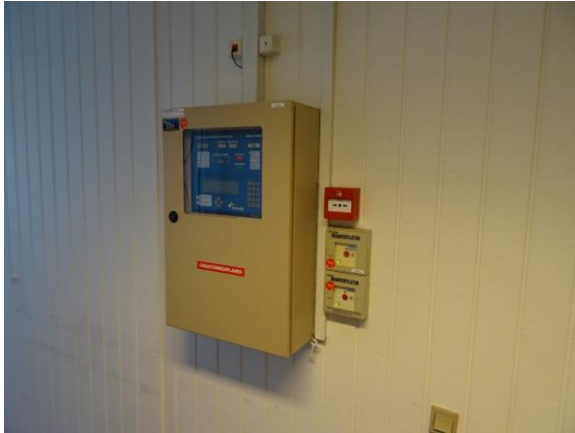
ABA central med fastnet alarmlinje
