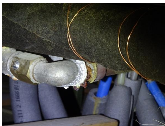
Tæring med svag udsivning over loft
