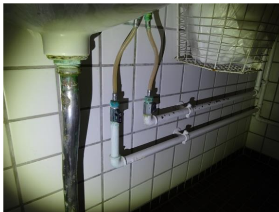
Vandforsyning til håndvask
