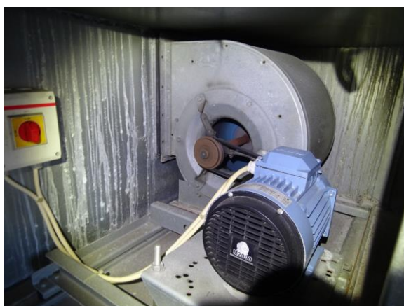
Ventilator i anlæg på tag
