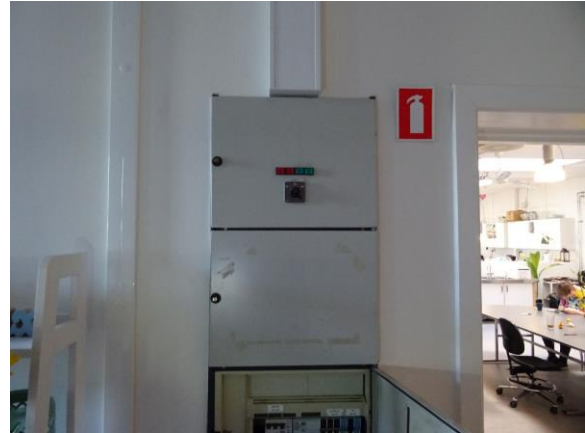
Funktionsløs ventilation styring
