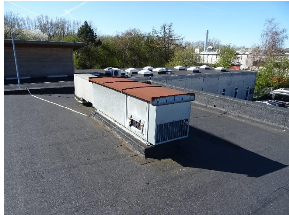
Dødt indblæsningsanlæg på tag
