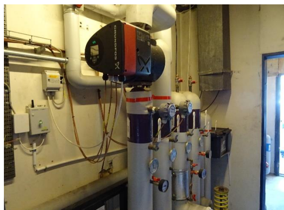
Hovedpumpe og varmfordeling
