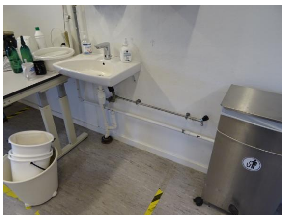
Postehane monteret på værksted uden afløb
