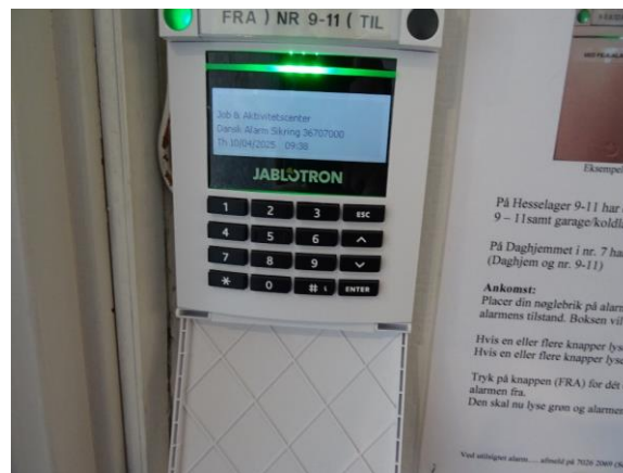
Kodetastatur for alarm
