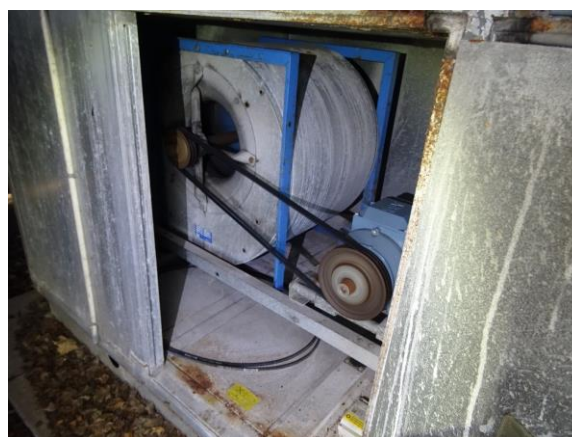
Ventilator i anlæg ved nordgavl
