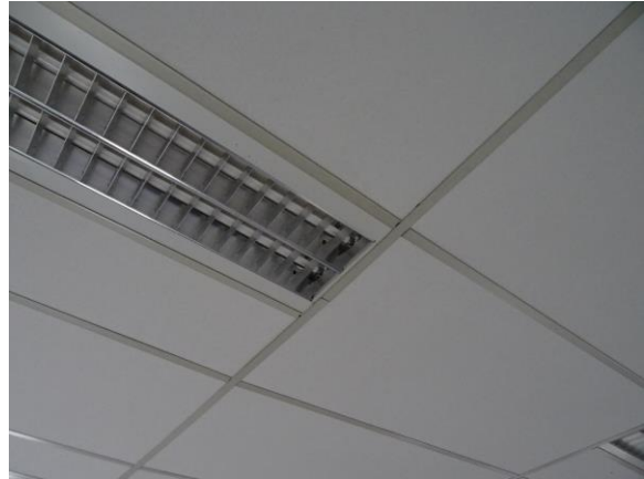
Belysningsarmatur med lysstofrør
