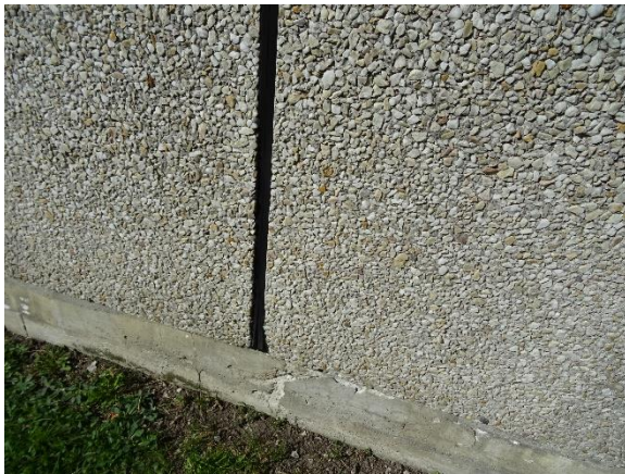
Sokkel med mindre skader
