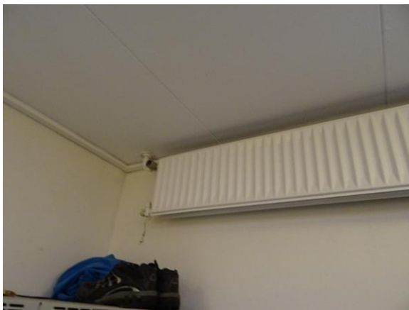
Radiatorventil fra opførelsen
