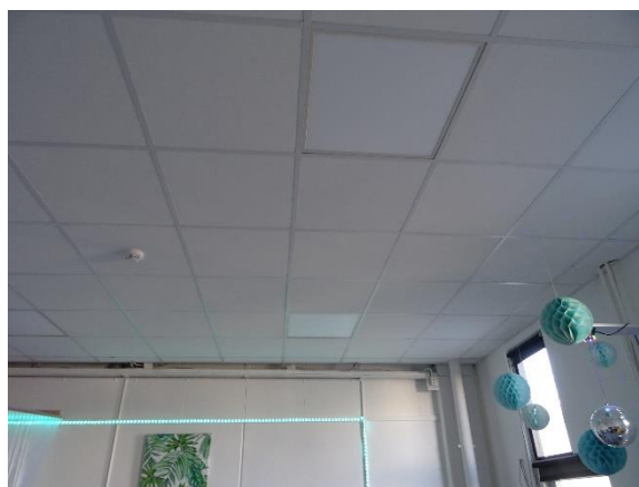
Enkelt rum skiftet til LED paneler
