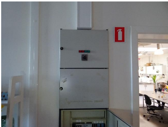
Udtjent ventilation styring
