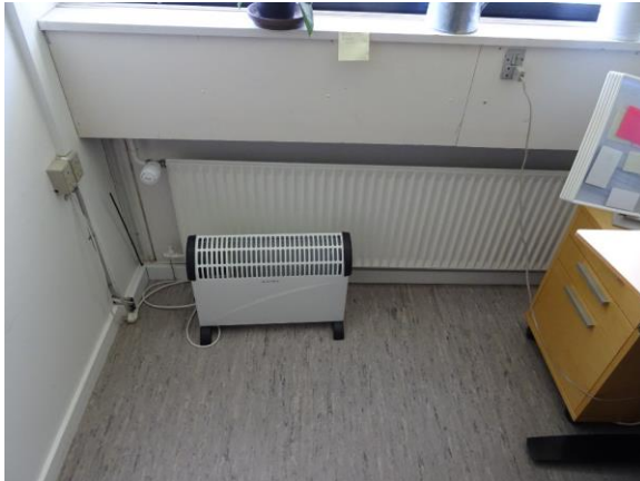
Et-lags radiator fra opførelsen – suppleret med elradiator
