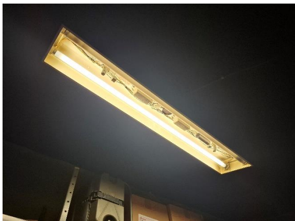
Bygning 1 – HF-armatur i depot.
