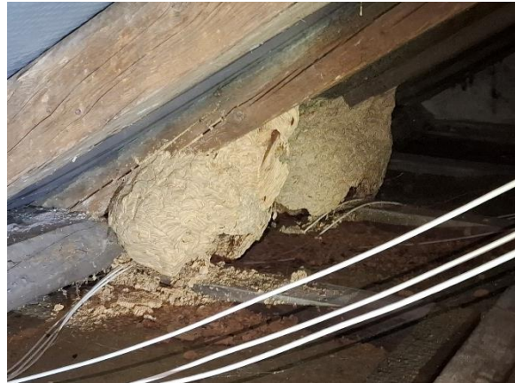
Bygning 2 – Der er store problemer med bier i skunke.
