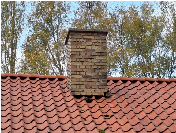
Bygning 2 - Skorsten uden inddækninger.
