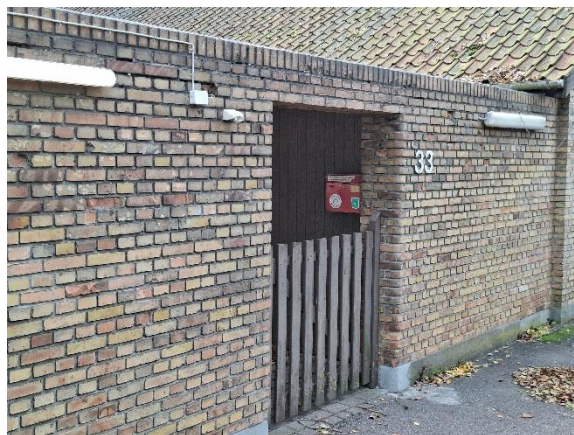
Murværk til overdækning mellem bygninger mangler af-dækning.
