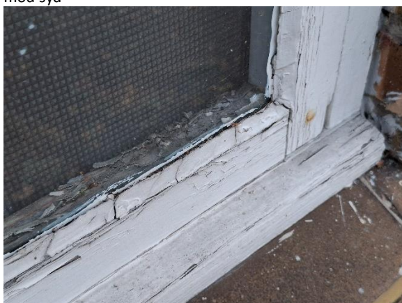
Bygning 2 – Afskallende maling og kit på vindue mod vest.
