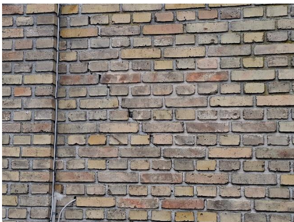
Bygning 1 – sætningsrevne i murværk mod vest
