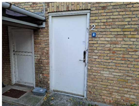
Bygning 2 – hoveddør og toiletdør.
