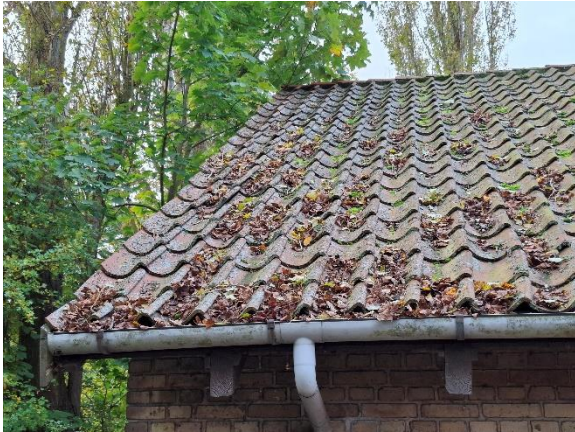
Bygning 1 - Tagsten ligger løse på bygning 1
