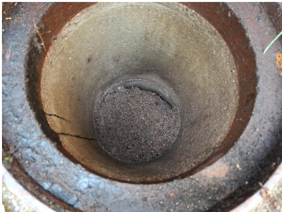
Sandfangsbrønd ved overdækning er tilstoppet.
