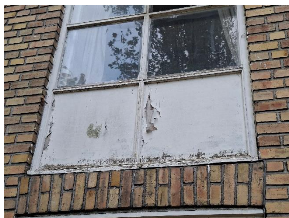
Bygning 2 – Afskallende maling på vindue mod nord
