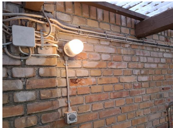
Udebelysning under overdækning
