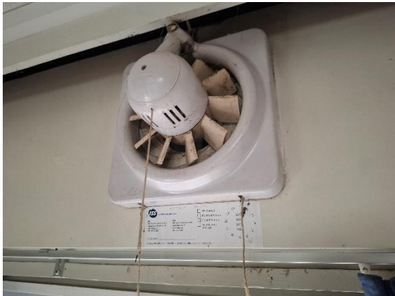
Bygning 1 – Ventilator i salen
