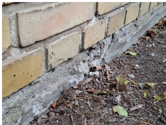
Bygning 1 – Afskallende puds på sokkel mod syd
