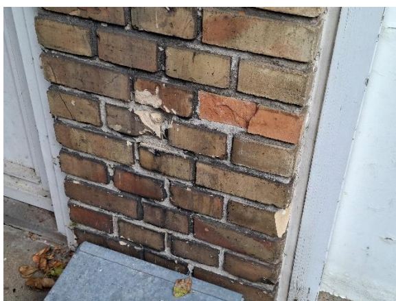
Bygning 2 – Skader på mursten under overdækning mod syd.
