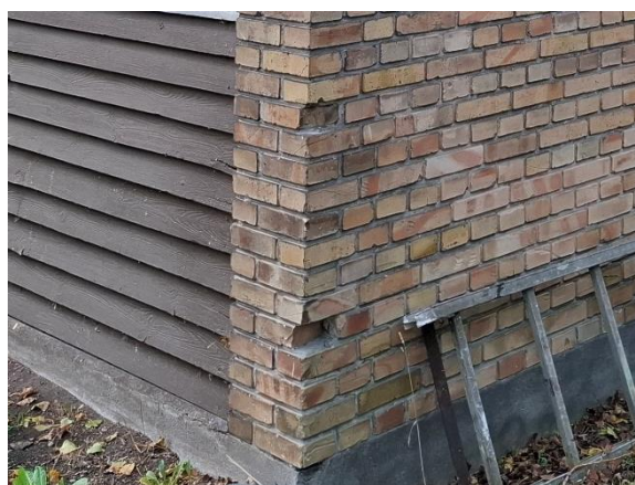
Bygning 2 – Knækkede sten og sokkelhjørne mod nordøst.
