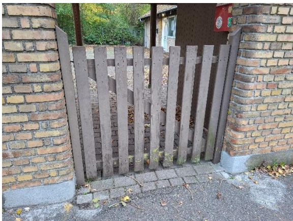
Låge i gennemgang er med algebegrøninger og afskallende maling.
