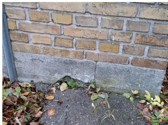
Bygning 1 – sætningsrevne ved hjørne mod sydvest
