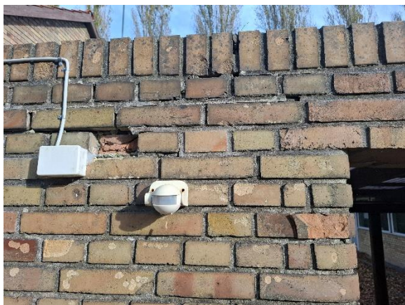
Afslag på teglsten og fuger på overdækning mellem bygninger tyder på fugt i murværket.
