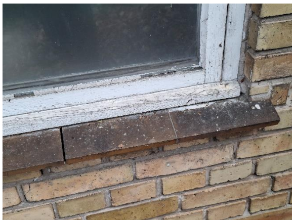
Bygning 1 – afskallende maling og krakeleret kit på vindue, fuger mellem sten i sålbænk delvist krakeleret
