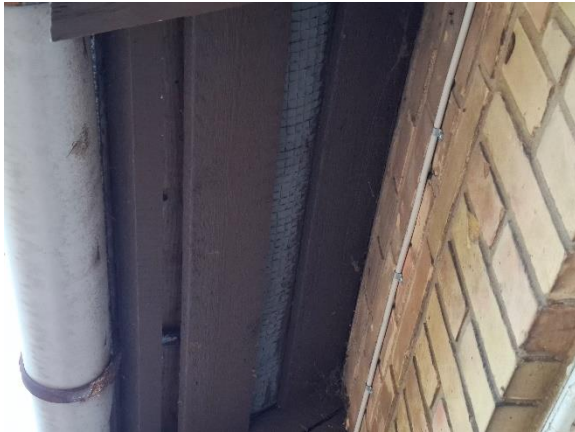
Bygning 2 - Undertag er synligt med risiko for nedbrydning fra UV-påvirkning.
