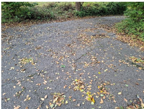
Asfaltbelægning på parkeringsplads er med revner, ujævnheder og bevoksning flere steder.
