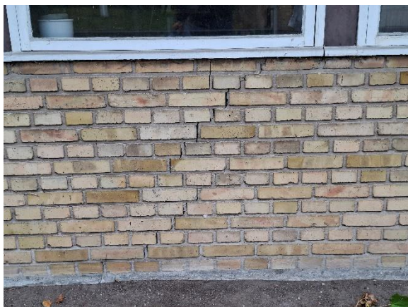
Bygning 1 – Sætningsrevne mod nord
