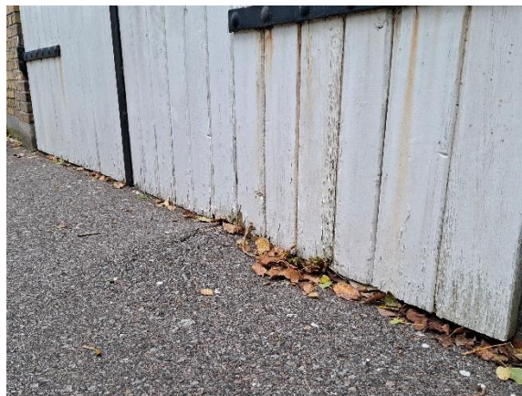
Bygning 1 - Træværket er med afskallende maling og råd nederst.
