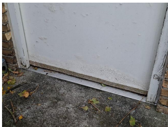
Bygning 2 – Hoveddør er opfugtet nederst og med afskallende maling.
