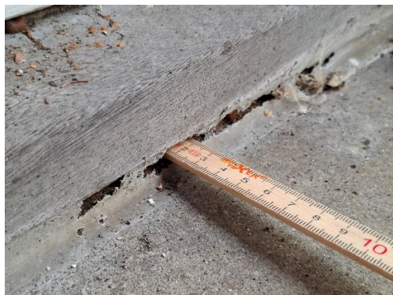
Bygning 2 – Dør under overdækning er med utætte fuger
