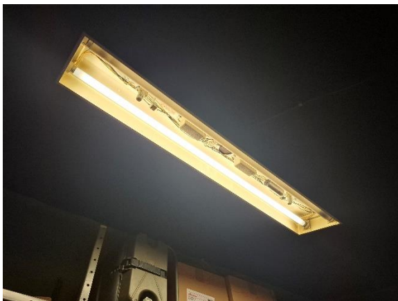
Bygning 1 – HF-armatur i depot.
