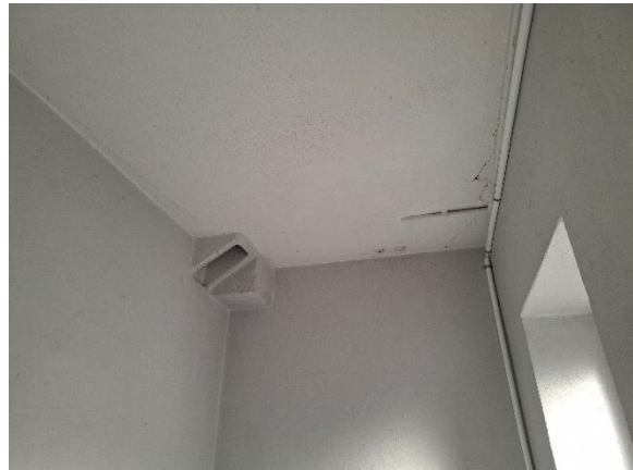
Bygning 2 – Aftræk i toiletrum
