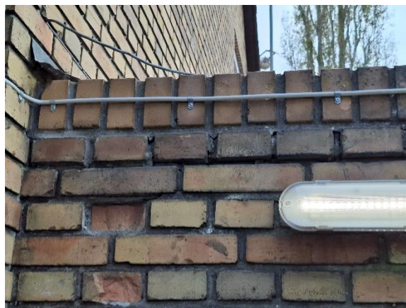
Murværk på overdækning mellem bygningerne er med frostskeer.
