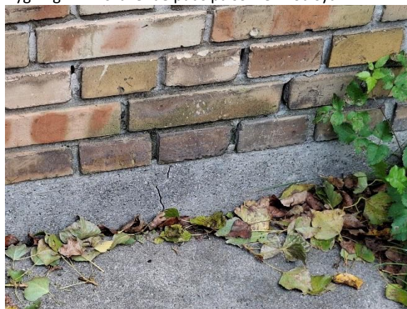
Bygning 2 – Revne i sokkel mod syd
