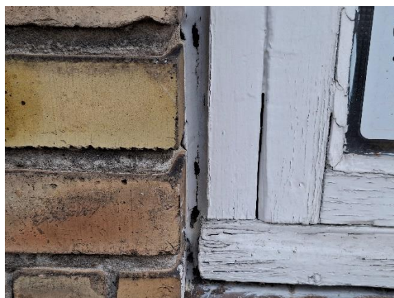
Bygning 2 – Afskallende maling og utæt fuge på vindue mod vest.
