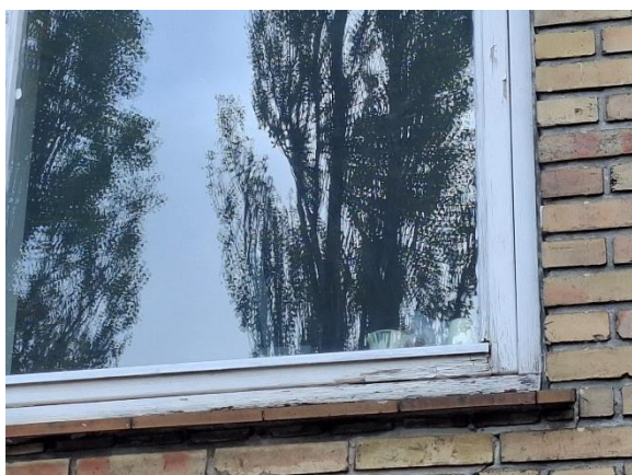
Bygning 2 – Afskallende maling og opfugtet træ på vindue mod syd
