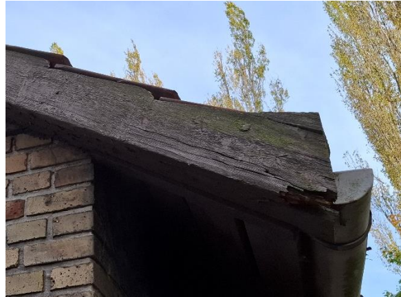
Bygning 2 – Vindskede med nedbrud i træværk.
