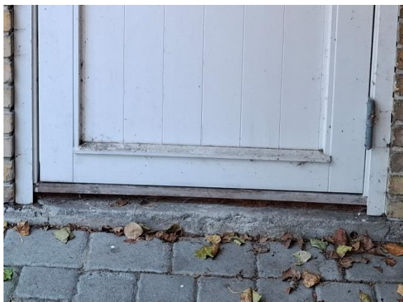
Bygning 1 – Fuge under dør under overdækning er ikke tæt.
