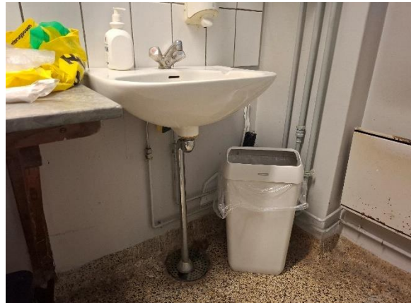
Håndvask med 2-grebs armatur
