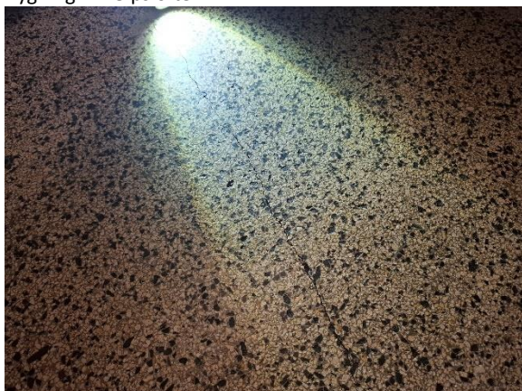
Bygning 2 – Terrazzogulv i stue er med revne enkelt sted i forrum til herretoilet.
