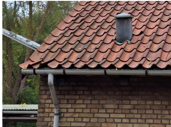
Bygning 2 - Løsliggende tagsten på bygning 2 mod sydøst
