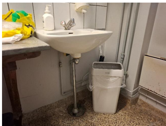
Håndvask med 2-grebs armatur
