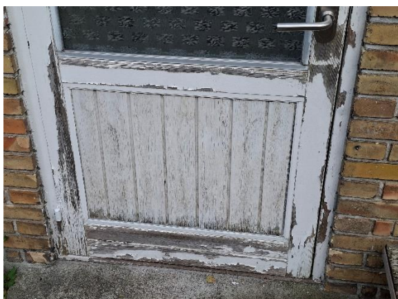
Bygning 2 – Toiletdør er med afskalninger i maling og råd i træ.
