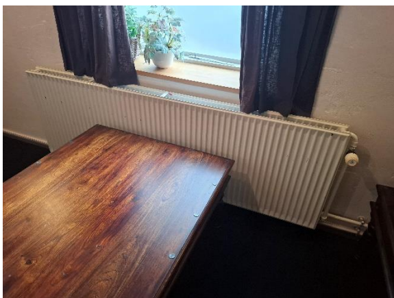
Bygning 1 – Radiator med termostatventil
