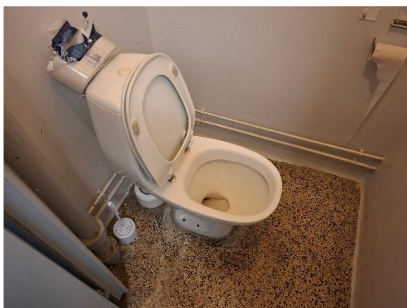
Toilet med 1 skyl
