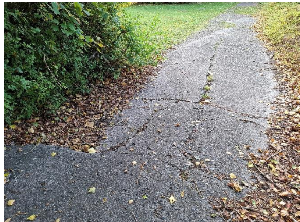
Asfaltbelægning på sti mod Sognevej 35 er ujævn og med revner.
