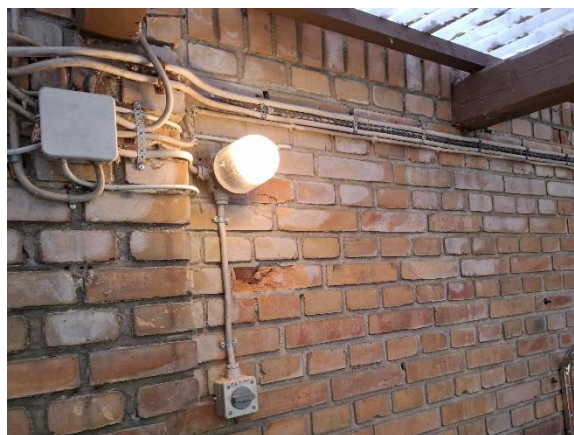
Udebelysning under overdækning
