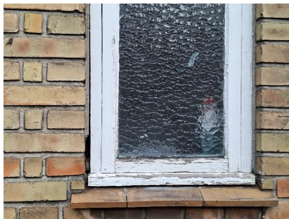
Bygning 2 – fuger er faldet ud og maling skaller af på vindue mod syd
