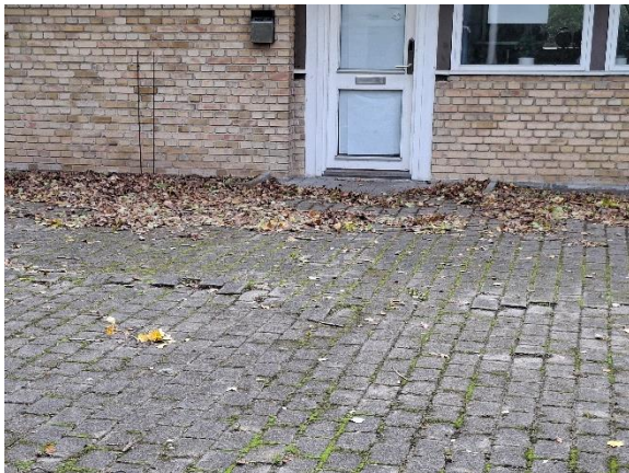
Flisebelægning i gård har skubbet sig op.
