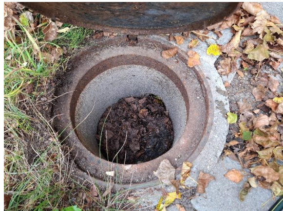
Sandfangsbrønd ved bygning 2 mod sydøst er tilstoppet.
