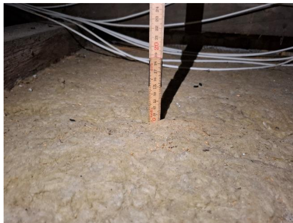
100 mm isolering i loftrum.
