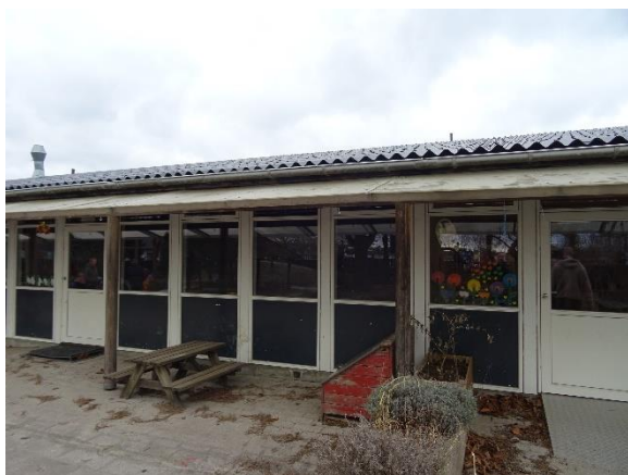
Døre i facade mod syd med 2-lags energiruder
