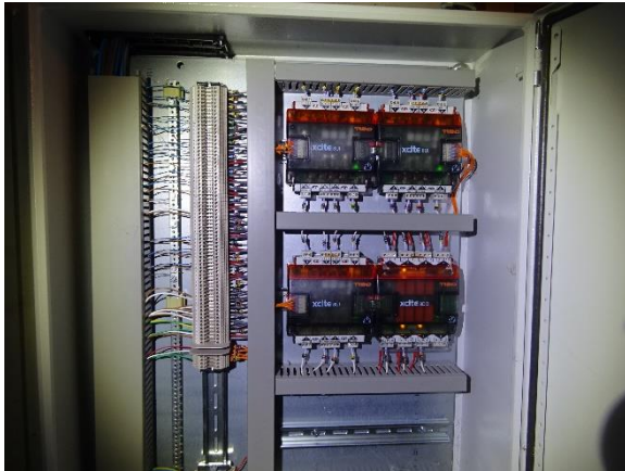
CTS understation i kælder
