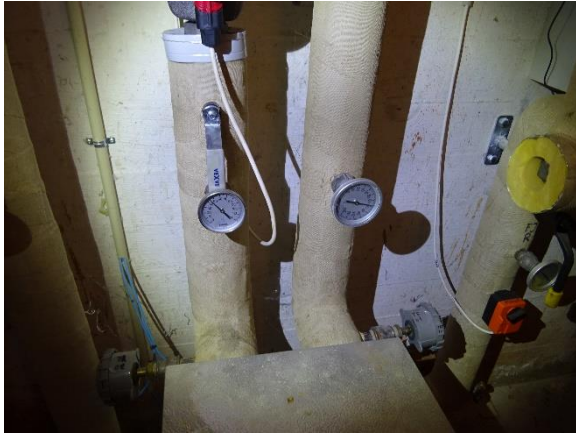
Varmeveksler og hovedpumpe
