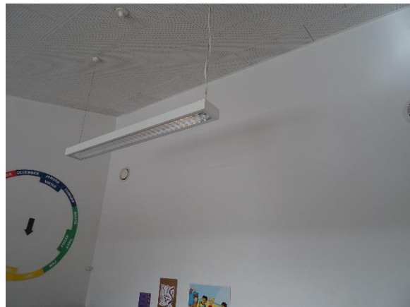
Nedhængt lysstofrørsarmatur på stue
