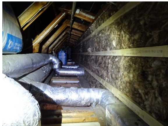
Ventilationskanaler over gang
