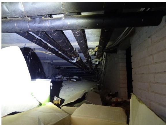
Hovedfordeling i krybekælder
