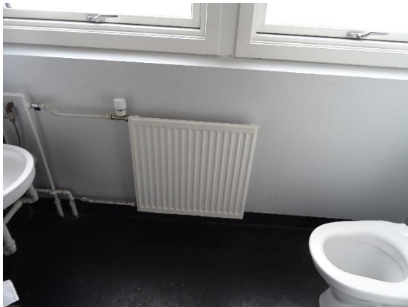
Radiator på facade
