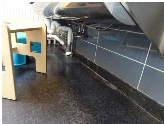
Rustfrie rør på børnetoilet
