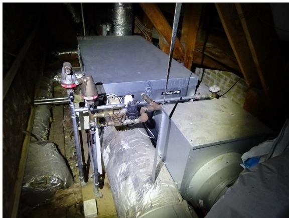
Ventilationsanlæg over gang
