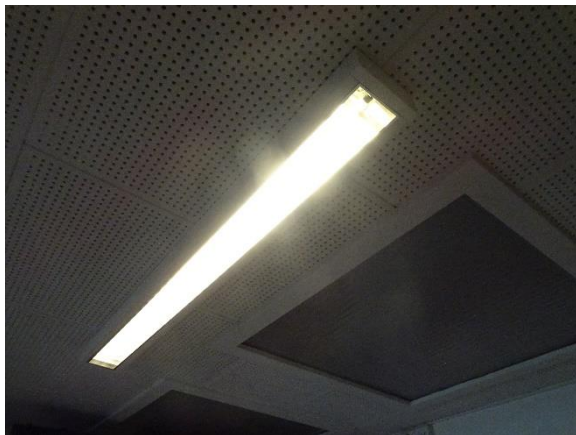
Loftmonteret lysstofrørsarmatur i gang
