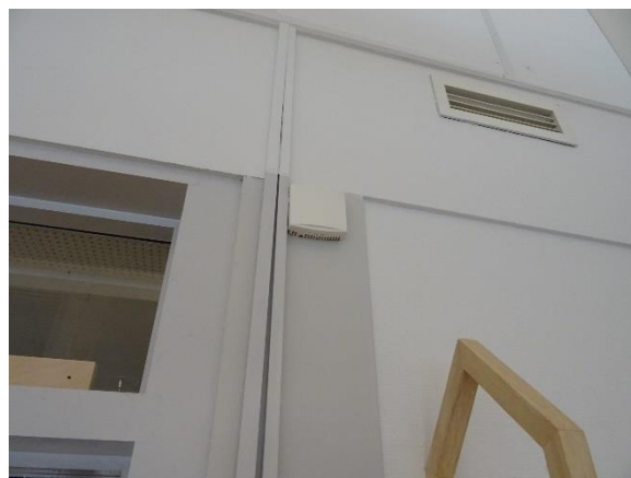
Temperaturføler og indblæsningsarmatur på stue
