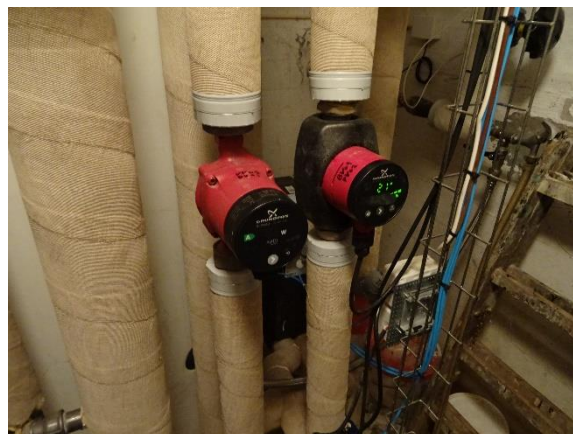
Veksler, beholder og pumpe for varmt vand. Pumpe til venstre er ikke i drift.
