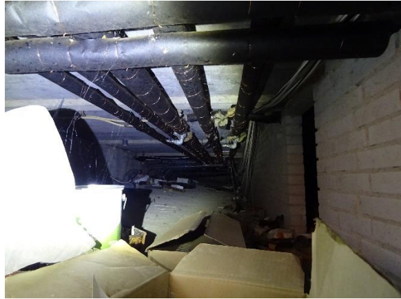
Fordelingsanlæg i krybekælder
