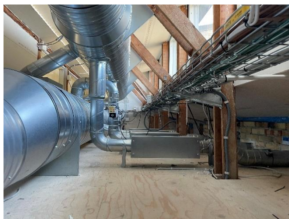
Rørføring over loftet.
