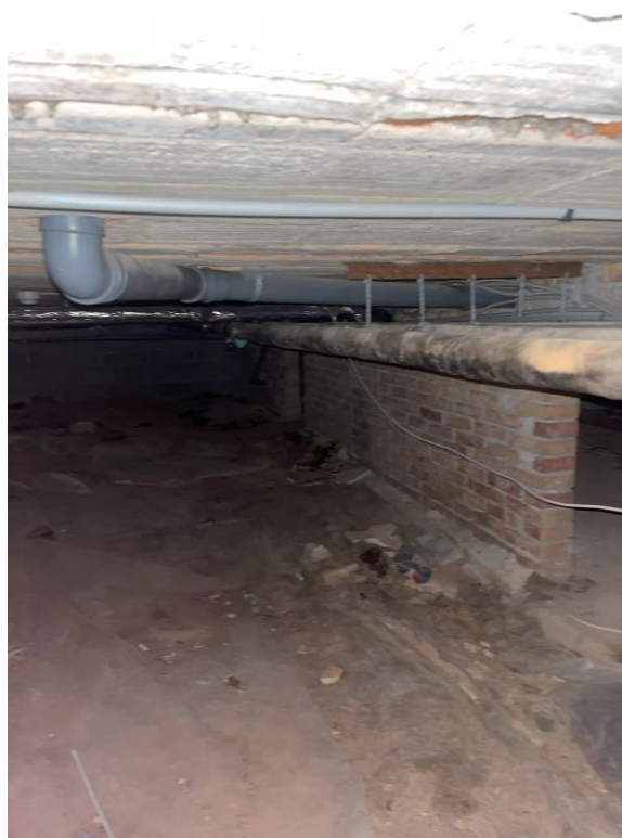
Faldstamme i krybekælder til toiletter
