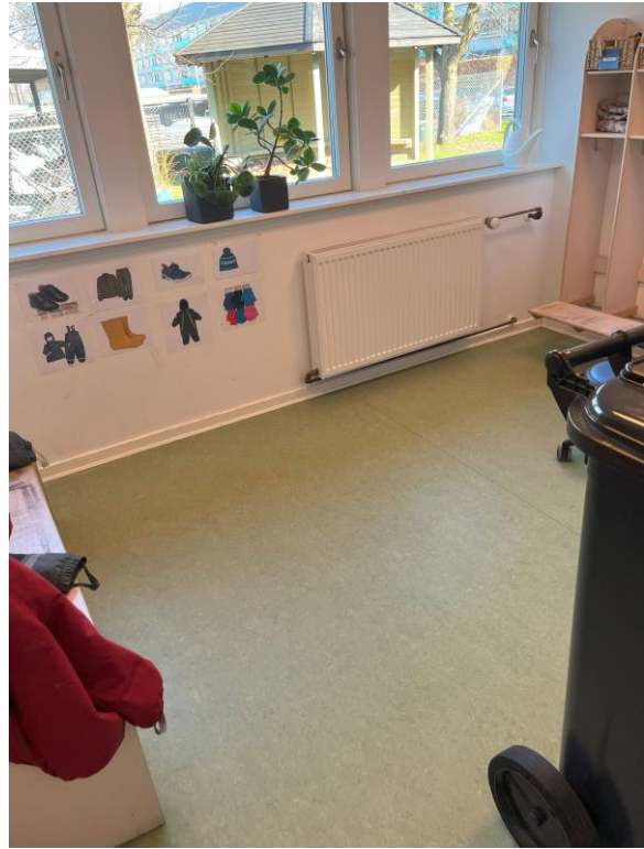
To strengs radiator, rør skjult bag væg ved generel fremføring.
