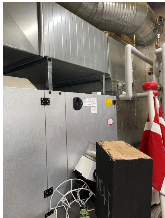
Ventilations aggregatet set fra siden
