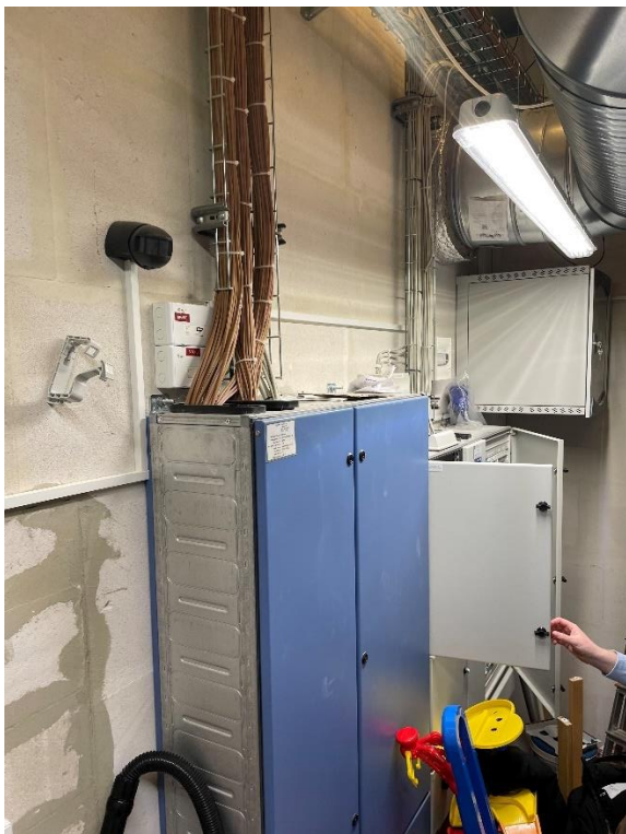
CTS-tavle placeret ved siden af hovedtavle
