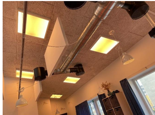
LED armaturer i lokale
