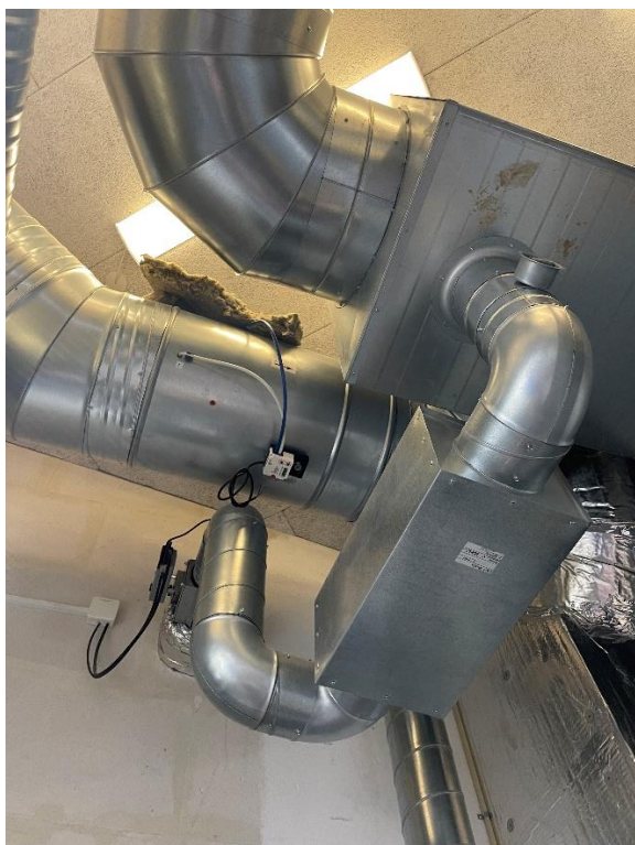
Rørføringen inde i teknikrummet
