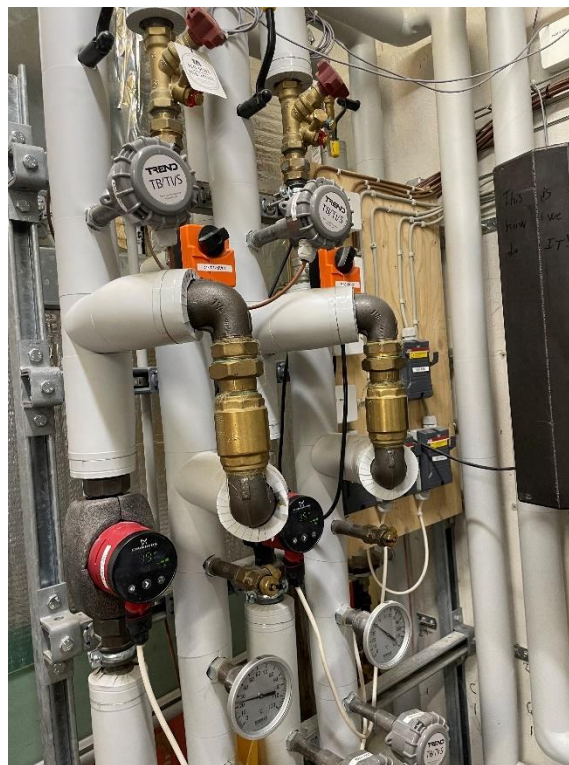
CTS styret anlæg
