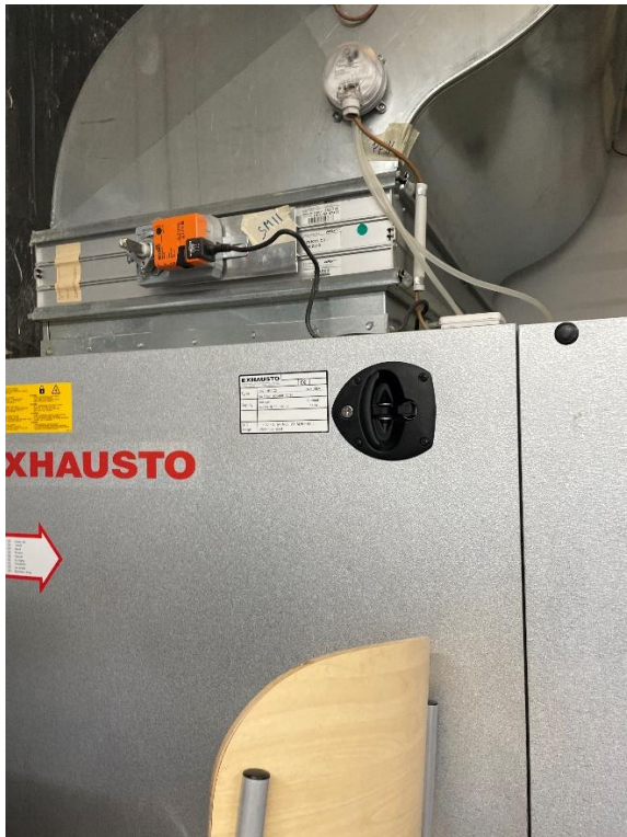
Mærkeplade på anlæg
