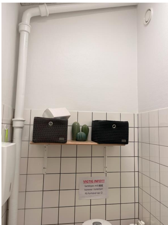
Ældre afløb med blystøbt samling
