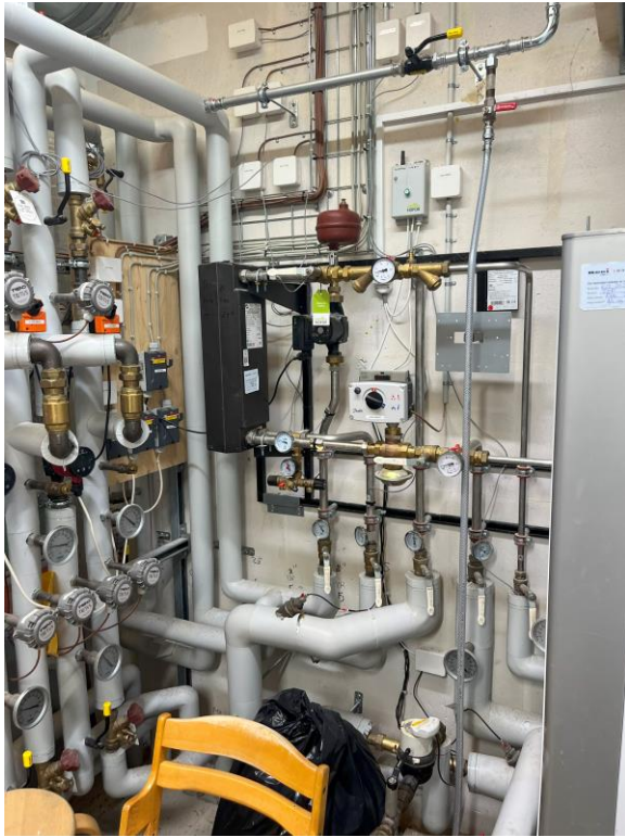
Varmeanlægget er CTS styret
