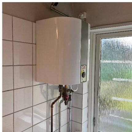
B2 El-vandvarmer på toilet
