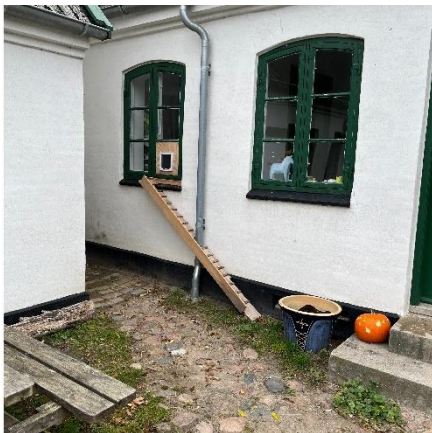
B1 Vinduer med etlag glas
