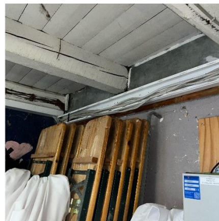
Manglende låg på vandret plastkanal i fyrrum
