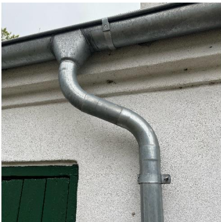
Tagrender og nedløb med galvaniseret stål
