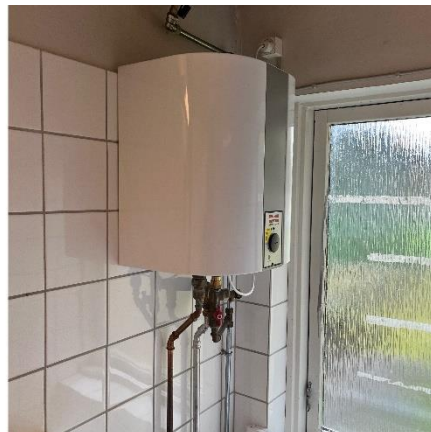
B2 El-vandvarmer på toilet
