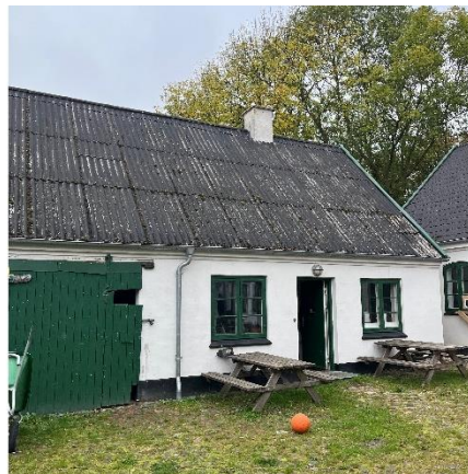
B2 Vinduer med etlag glas
