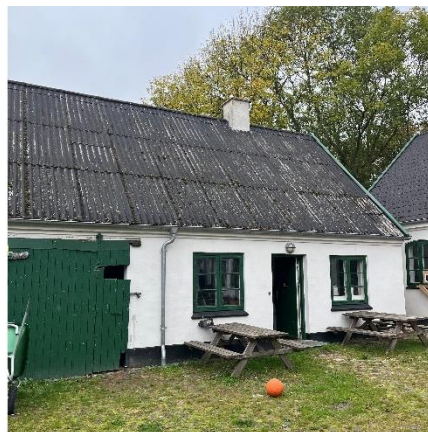
B2 Vinduer med etlag glas
